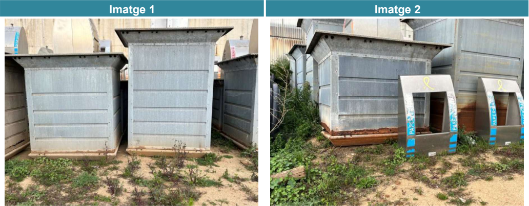
Contenidors metàl·lics amb senyals d'oxidació i deformacions lleus. Es mantenen fixats a la base però mostren desgast visible als panells i portes.
