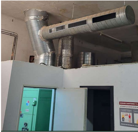
Imatge 3: Sistema de calefacció
