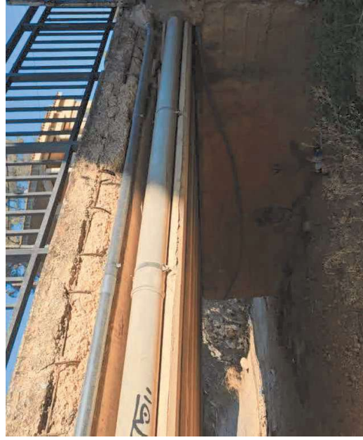
BIGA 10 ESTREP 1 Reforços del formigó al descobert
