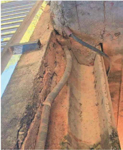
BIGA 1 ESTREP 2 Fixació de la canalització deficient
