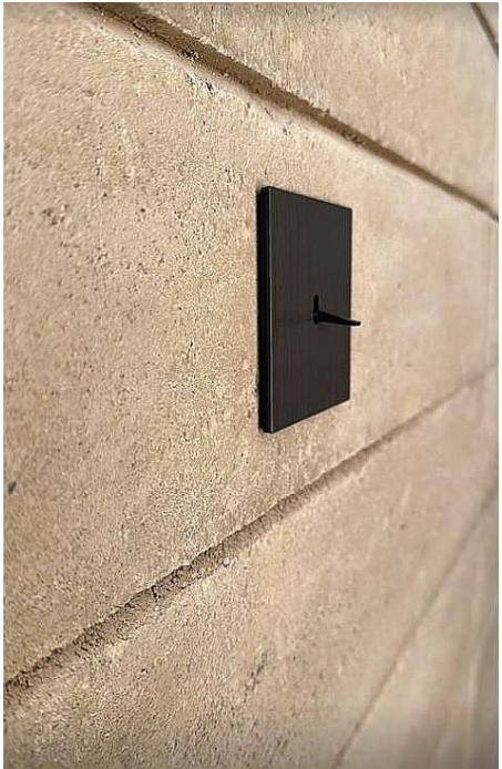
Ref. 01 Detalle de los interruptores Switches detail
