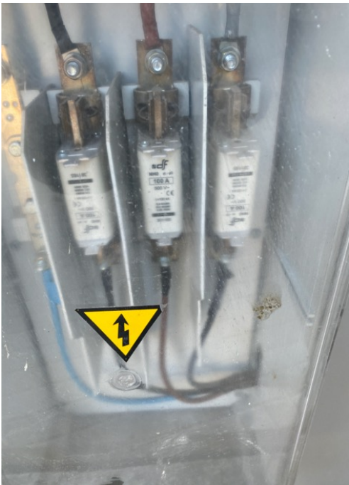
Imatge 6: Fusibles escomesa
