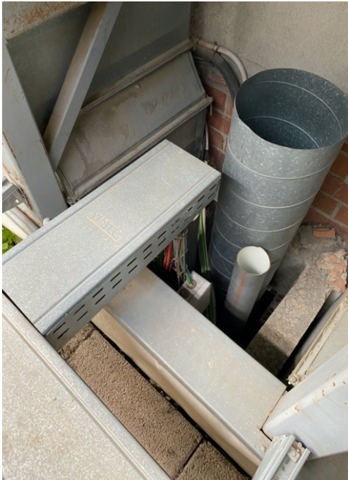
Imatge 4: Pas vertical de cablejat des de planta coberta fins a QGBT en planta baixa
