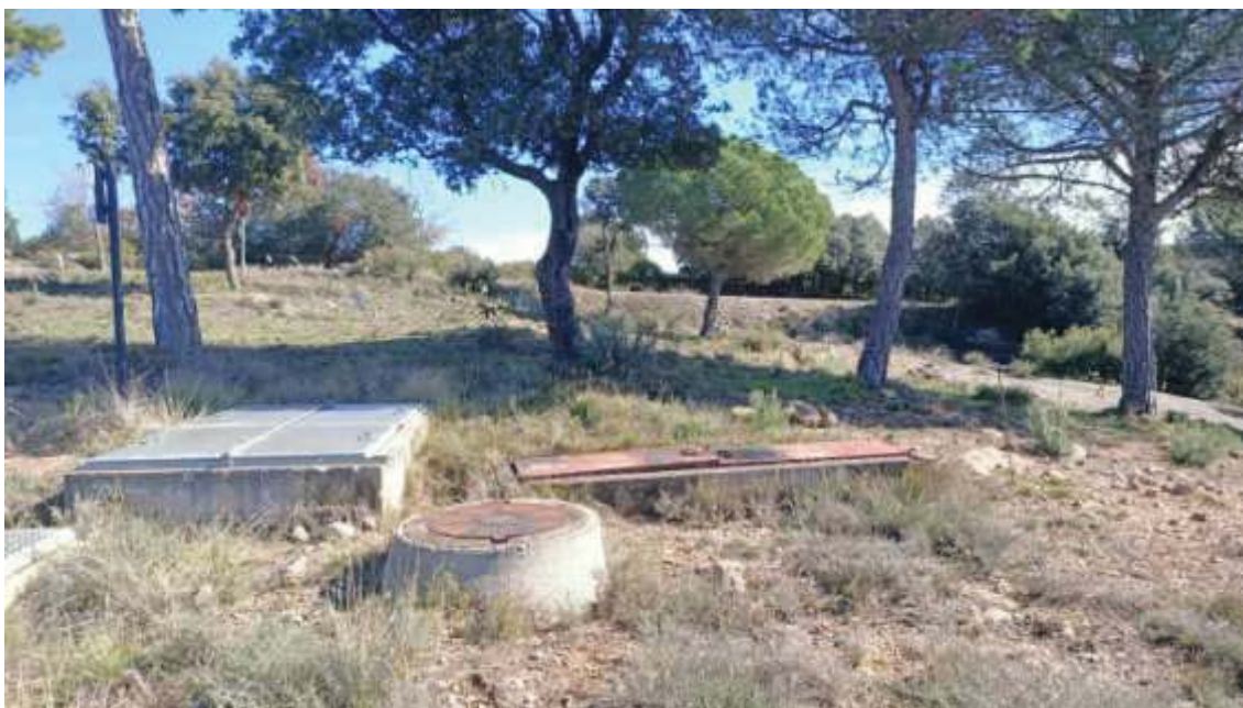
Pujol de Planés. Inici actuació arqueta amb vàlvula reductora de pressió
