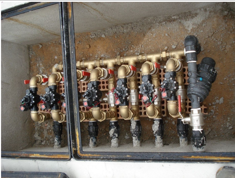
Interior pericó amb bateria de reg 50Ø més filtre
