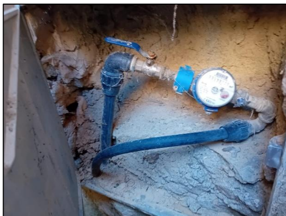
Foto 7. Comptador en arqueta enterrada al carrer La Rabassa.
