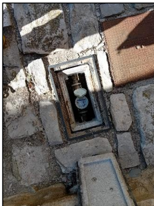
Foto 5. Comptador en arqueta integrada al paviment del carrer La Rabassa.
