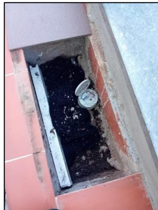
Foto 4. Comptador en arqueta exterior al carrer Tarragona.
