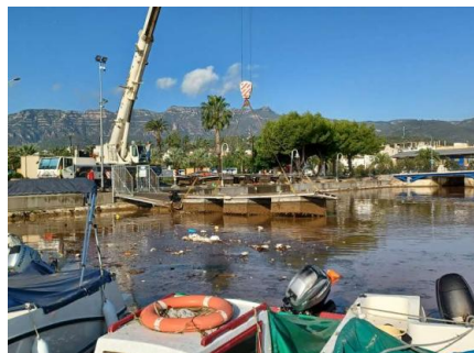
Retirada del pantalà trencat
