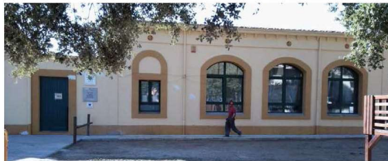
Vista de la façana de l'escola on s'observen les esquerdes.
