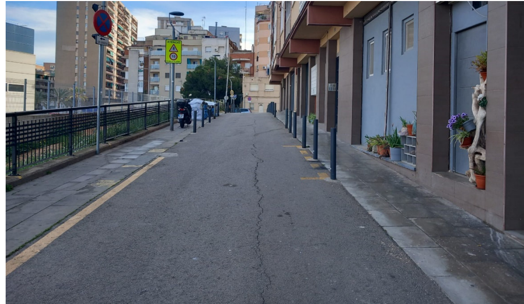
Figura 1: Fissures Carrer Esmaragda 12-14
