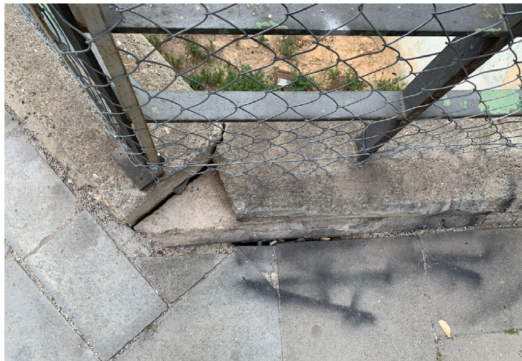
Figura 6: Desconnexió entre murs a Esmaragda 10-12
