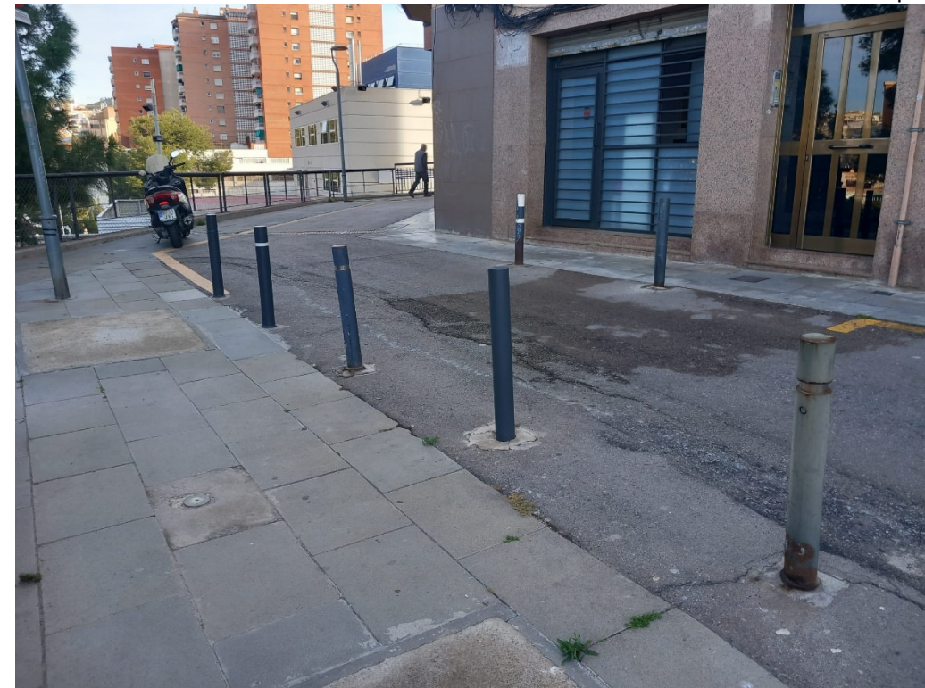
Figura 3: Fissures cantonada Carrer Esmaragda 10-12
