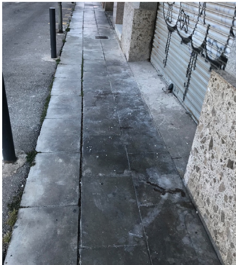
Figura 10: Separació del paviment respecte la façana del Carrer Esmaragda 4-6
