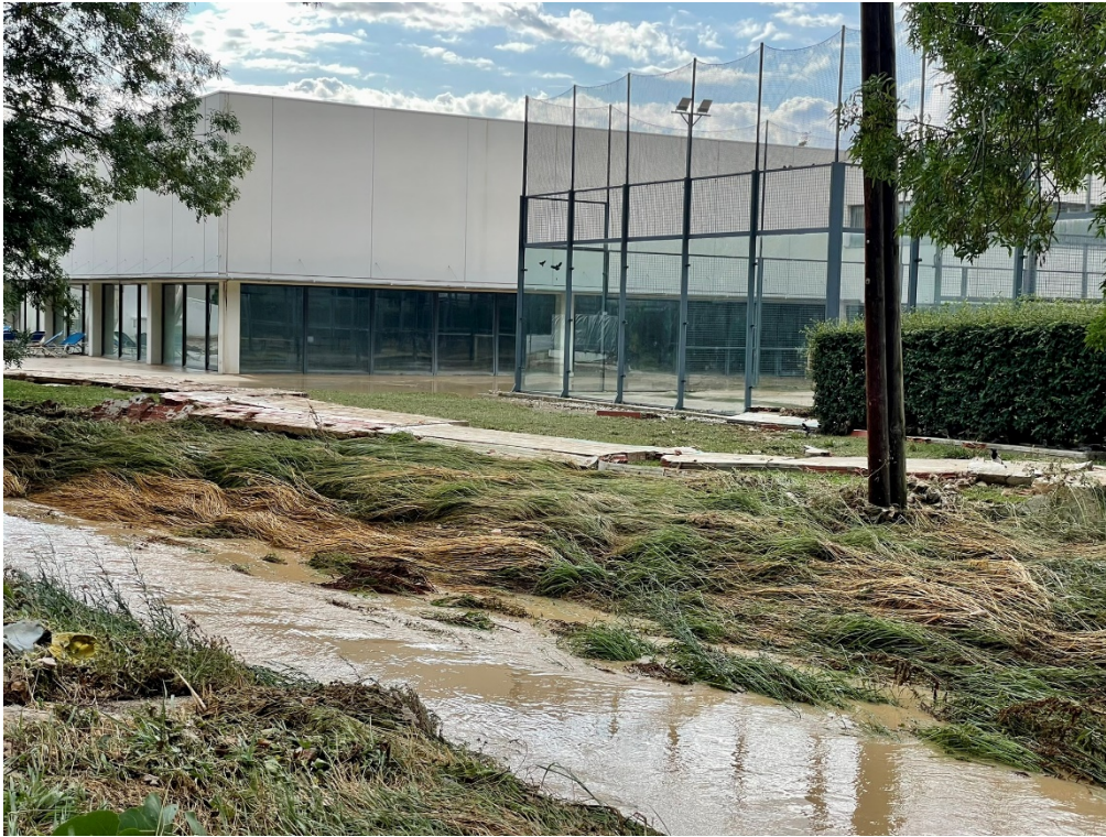
F1. Mur exterior col·lapsat per efecte de l'empenta de l'aigua de la rasa dels Vinots.
