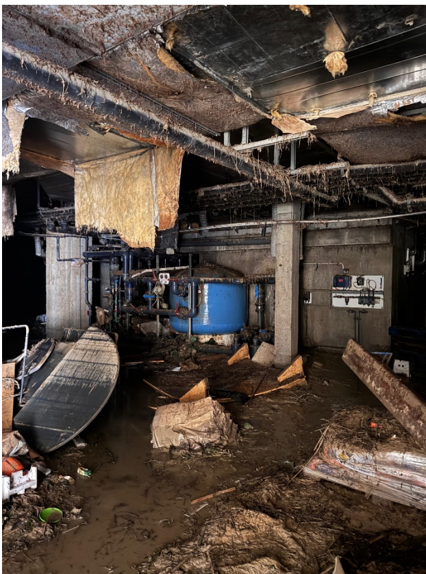
F8. Planta soterrani. Zona filtratge després del buidat.
