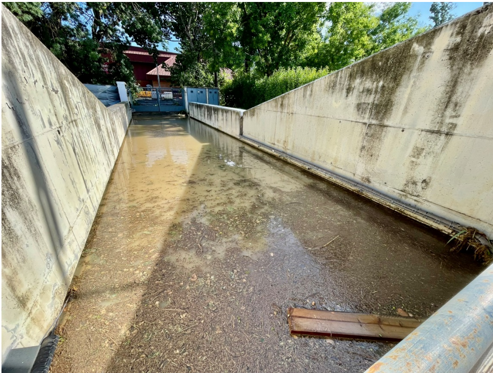
F2. Rampa d'accés al soterrani després de l'aiguat.
