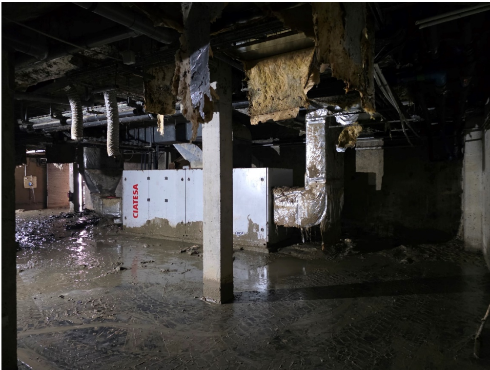
F11. Planta soterrani. Deshumectadora 2 després del buidat.
