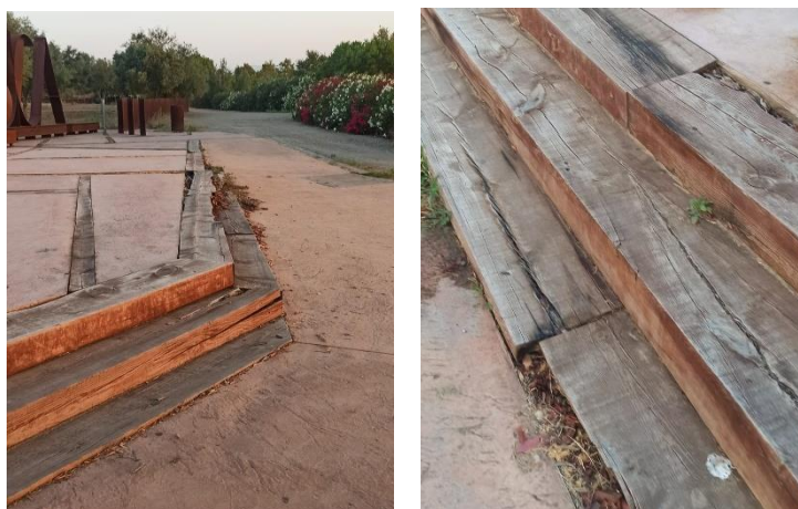
Img 2. Fotografies de les travesses malmeses a l'entrada del parc (visita al parc del dia 01/09/2025)
