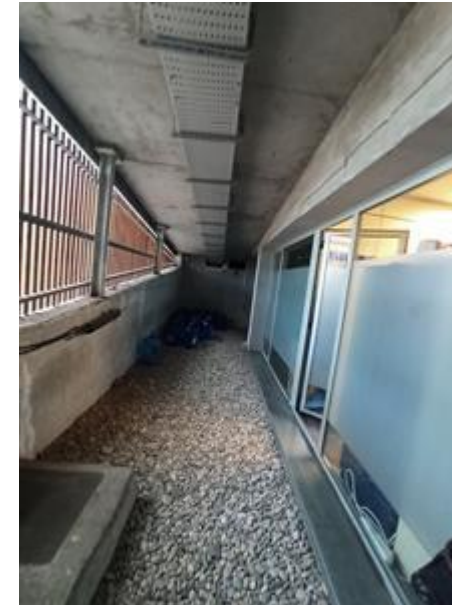
Imatge 43. Estructura metàl·lica a reparar
