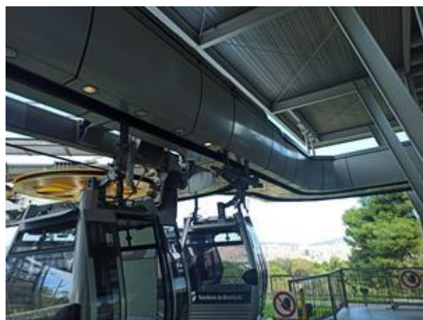
Imatge 36. Estructura metàl·lica a reparar
