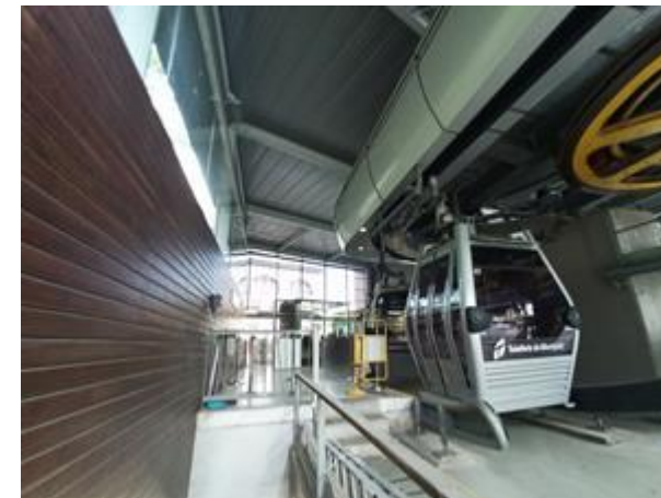
Imatge 23. Cabina telefèric
