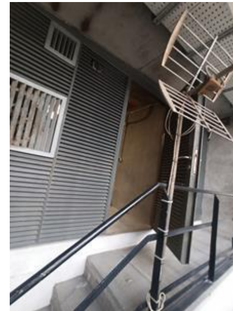
Imatge 67. Accés sala tècnica
