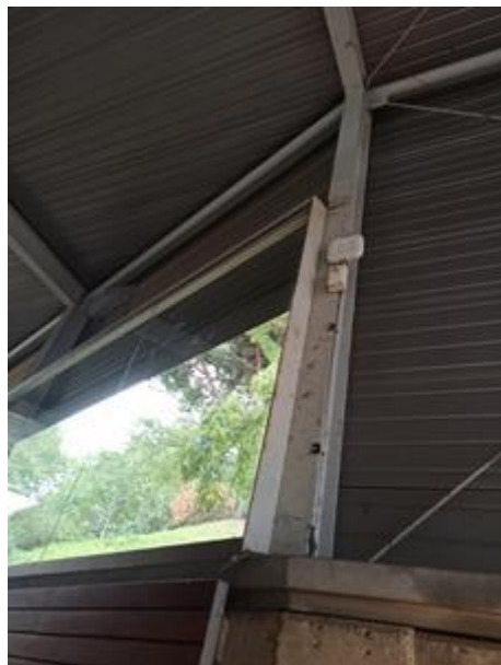
Imatge 4. Estructura metàl·lica a reparar
