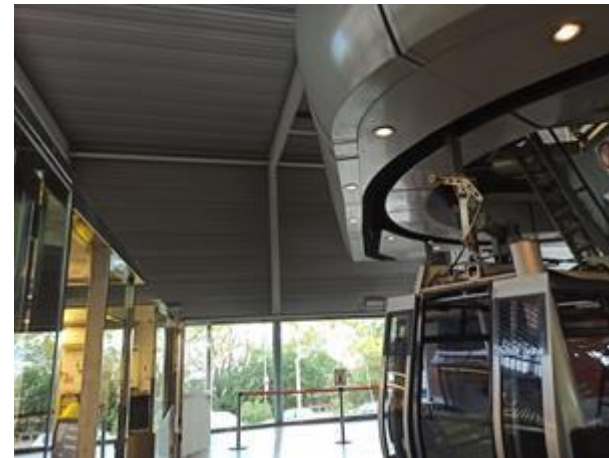
Imatge 26. Enllumenat andana telefèric
