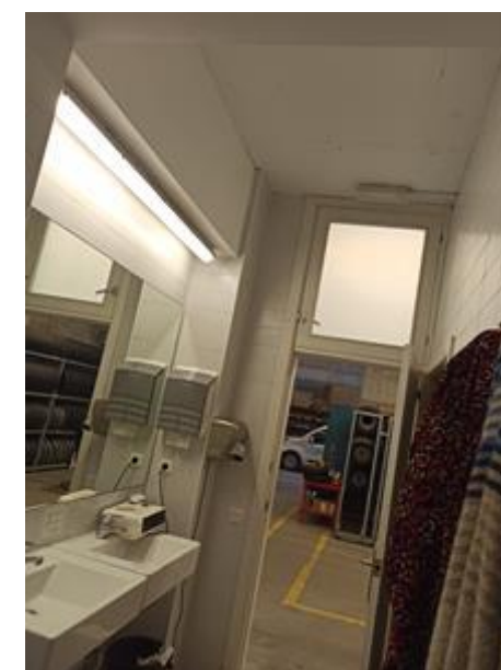
Imatge 52. Porta i finestra superior a substituir
