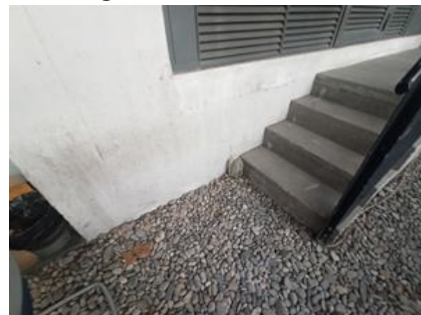
Imatge 66. Accés sala tècnica
