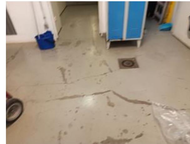
Imatge 55. Zona àrees tècniques
