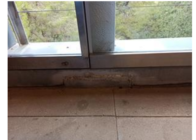
Imatge 60. Estructura metàl·lica a reparar
