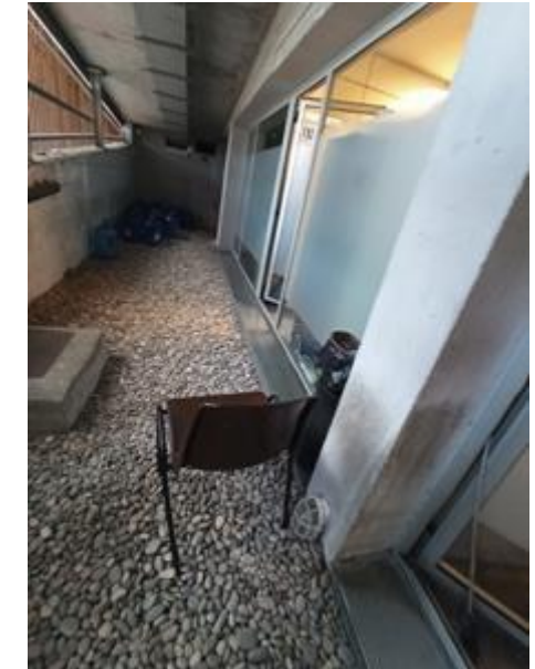
Imatge 44. Estructura metàl·lica a reparar
