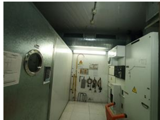
Imatge 64. Centre de transformació
