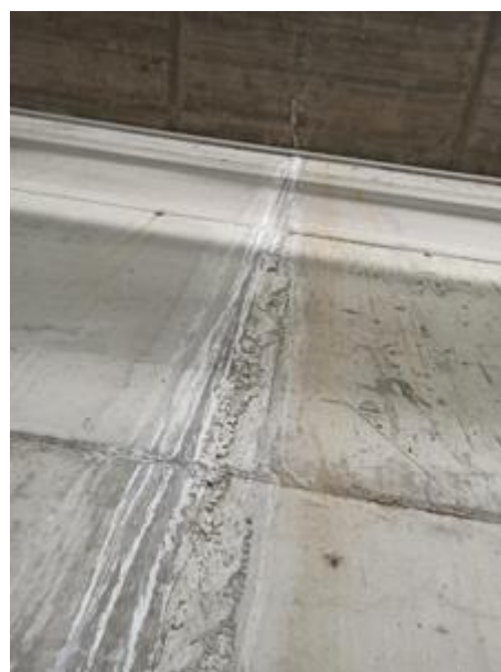
Imatge 49. Filtracions al taller
