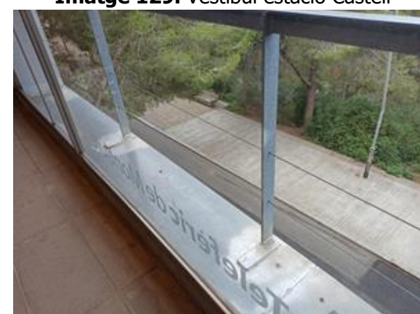
Imatge 131. Estructura metàl·lica a reparar
