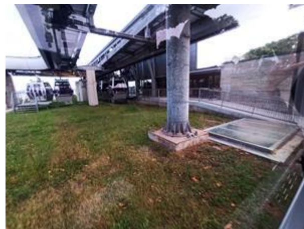
Imatge 51. Lluerna i base pilona a reparar
