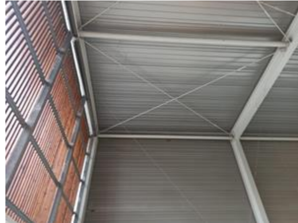
Imatge 3. Estructura metàl·lica a reparar
