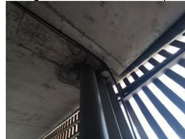
Imatge 45. Estructura metàl·lica a reparar
