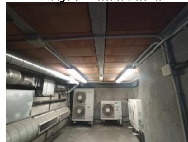
Imatge 69. Sala tècnica
