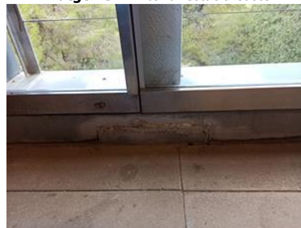
Imatge 136. Estructura metàl·lica a reparar
