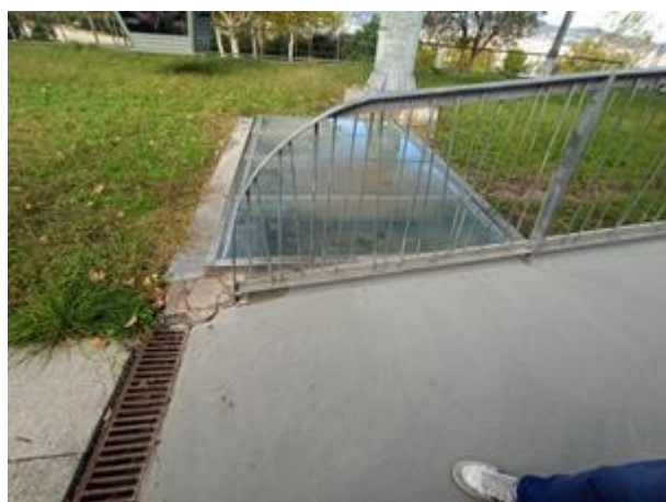
Imatge 50. Lluerna a reparar
