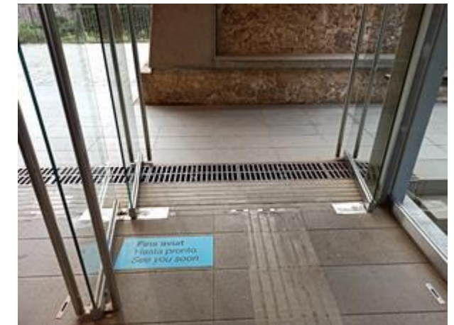
Imatge 66. Sistema de tancament a substituir
