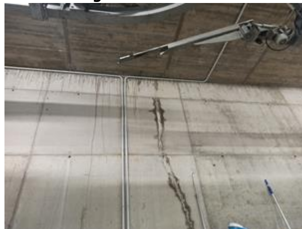
Imatge 111. Filtracions taller
