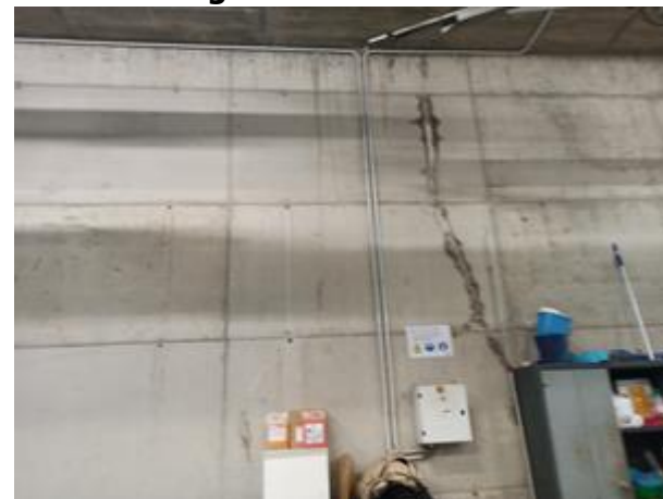
Imatge 112. Filtracions taller
