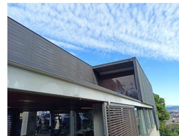
Imatge 42. Accés a estació amb filtracions a reparar
