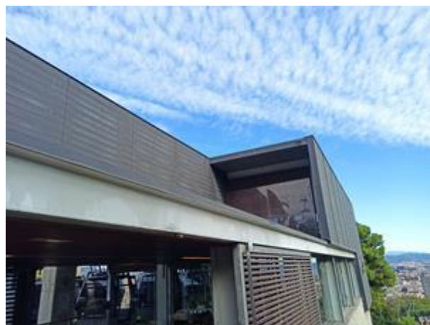
Imatge 38. Estructura metàl·lica a reparar
