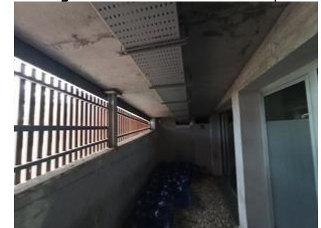
Imatge 46. Estructura metàl·lica a reparar
