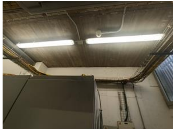
Imatge 61. Zona àrees tècniques
