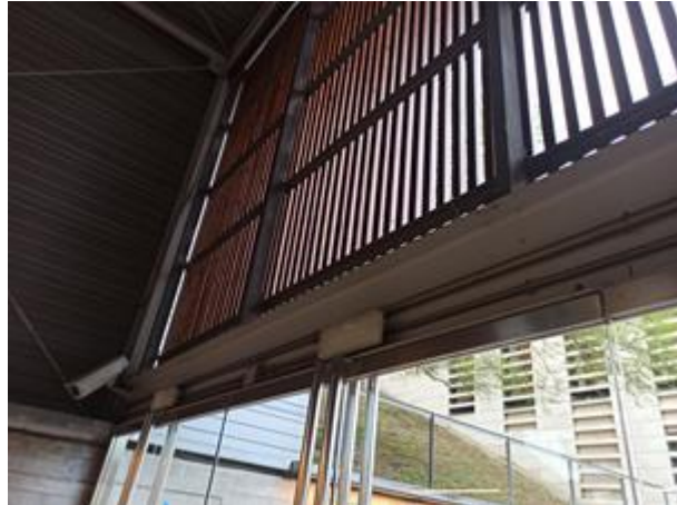
Imatge 2. Estructura metàl·lica a reparar
