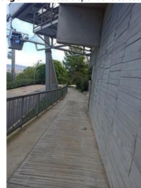
Imatge 143. Rampa d'accés a armaris
