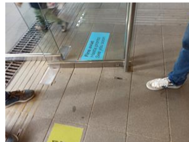
Imatge 65. Sistema de tancament a substituir
