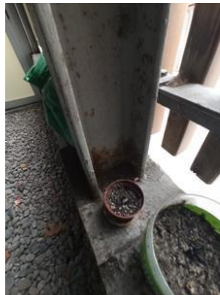
Imatge 5. Estructura metàl·lica a reparar
