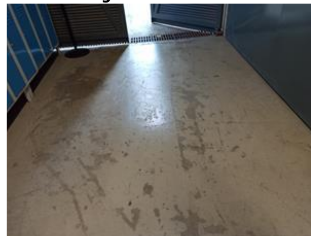
Imatge 54. Zona àrees tècniques
