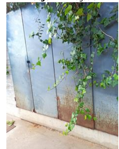
Imatge 144. Portes armaris a substituir
