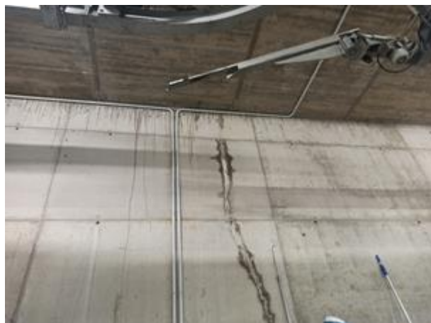
Imatge 48. Filtracions al taller
