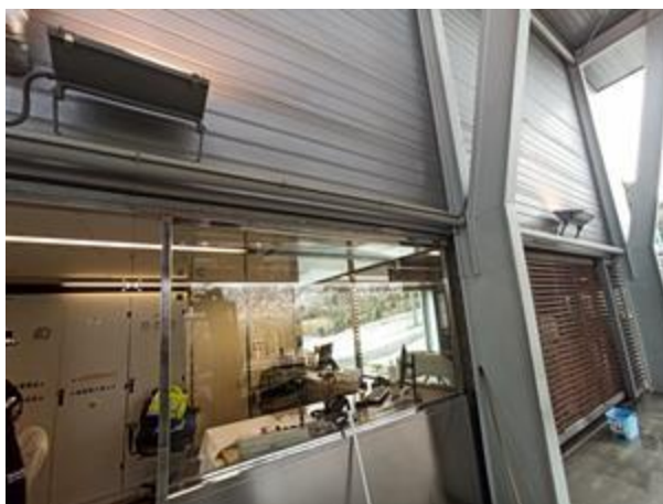
CGE amb filtracions a reparar
