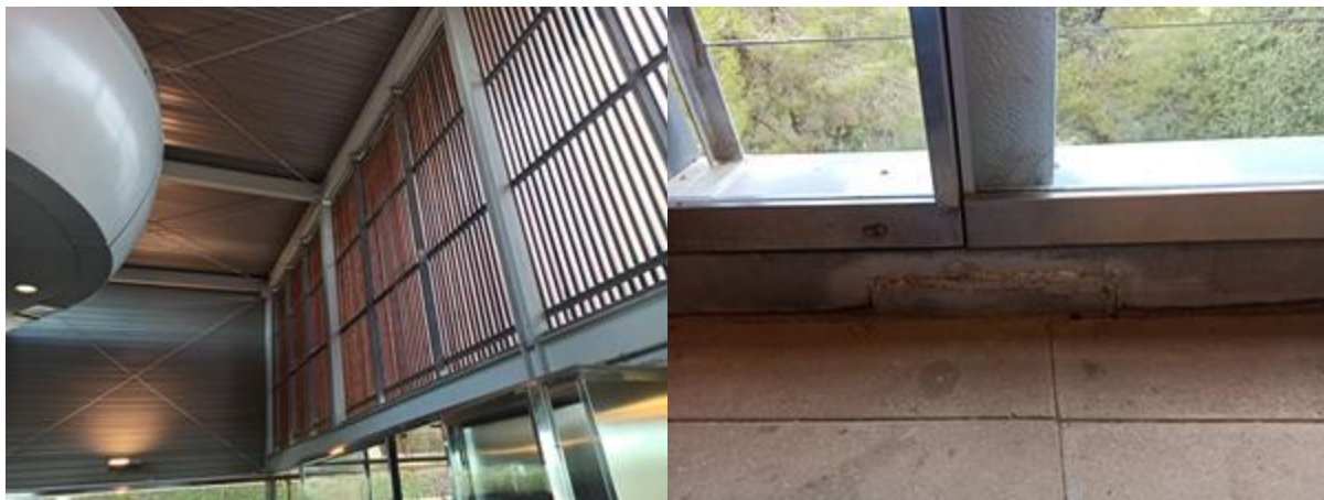
Estructura metàl·lica a reparar
