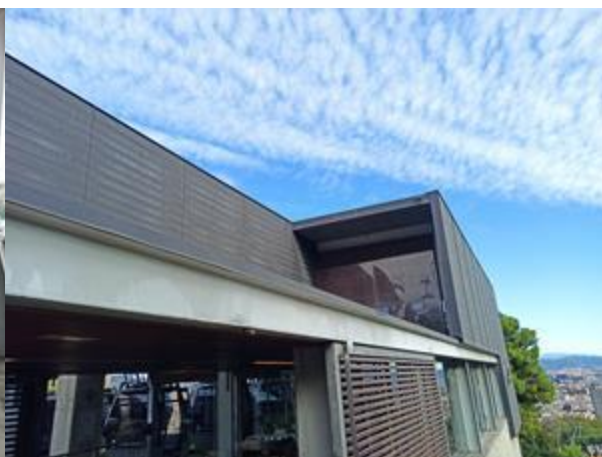
Accés a estació amb filtracions a reparar
