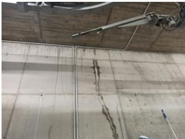
Filtracions al taller
