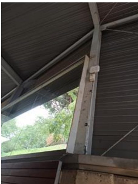
Estructura metàl·lica a reparar
