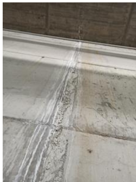
Filtracions al taller
