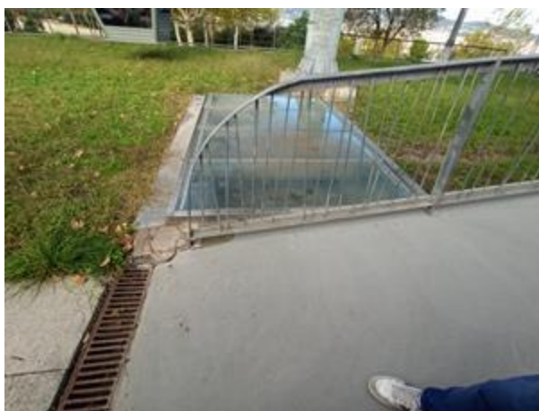
Lluerna a reparar
