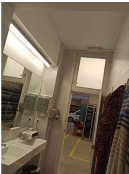
Porta i finestra superior a substituir
