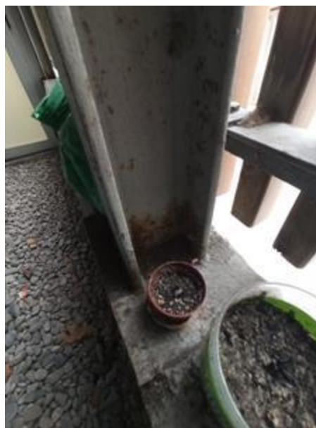
Estructura metàl·lica a reparar
