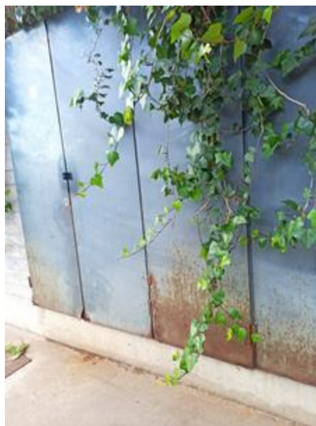
Portes exteriors a substituir
