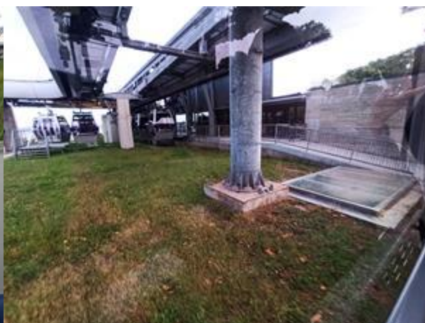
Lluerna i base piona a reparar
