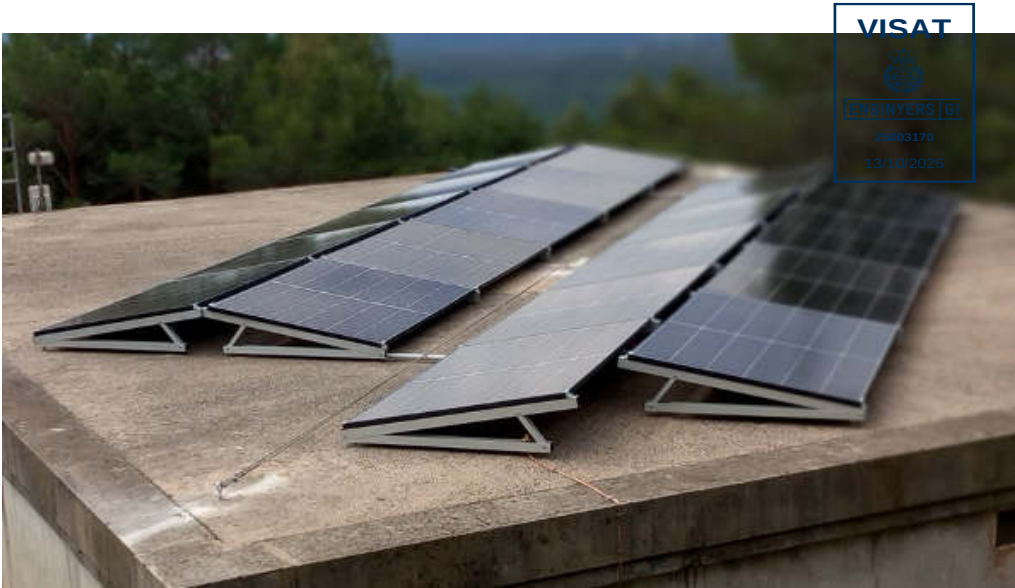
Configuració actual de la instal·lació fotovoltaica sobre el dipòsit d'aigua de Sales de Llierca
