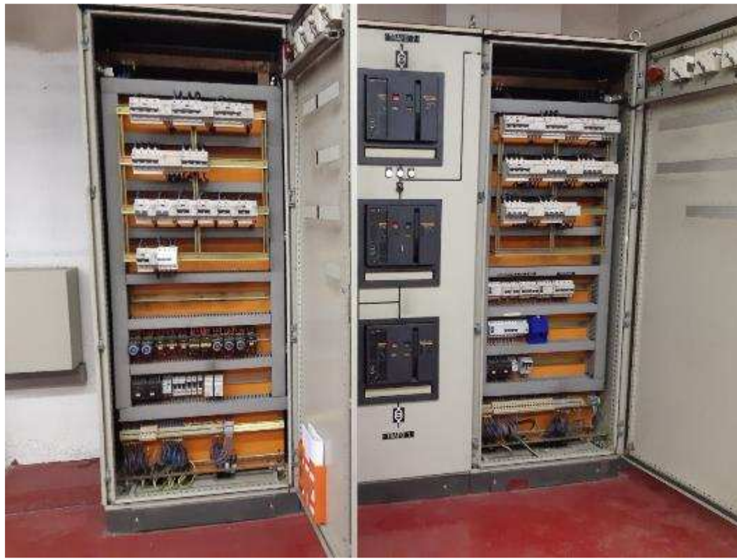
Imatge 23. Detall del quadre de commutació de baixa tensió (11)
