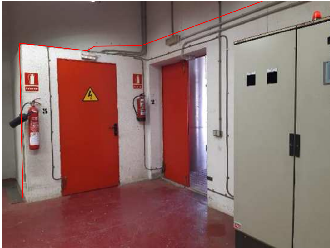
Imatge 25. Detall d'estesa des de nou armari (2), dins de la planta carrer de la ST d'Autogeneració
