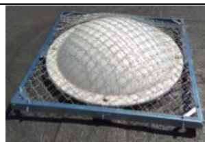
Figura 3. Ejemplo protección claraboyas con enrejado
