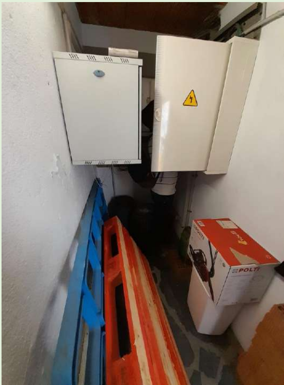
Exemple d'una sala tècnica amb quadres elèctrics utilitzat a la vegada com a magatzem.
