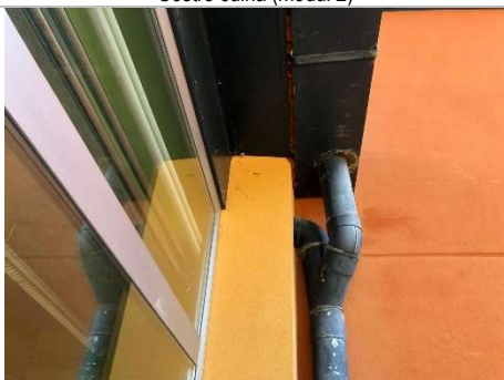
Embocadura de baixant amb canaló. Manca d'estanqueïtat
