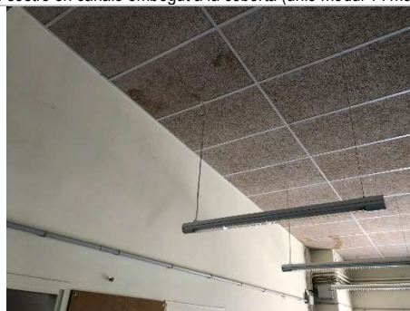
Sostre menjador. Plaques en mal estat per filtracions de la coberta.
