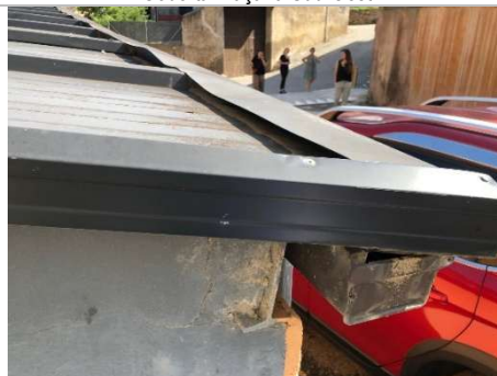
Remats de la coberta mal executats.
