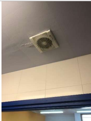
Filtracions d'aigua per conductes de ventilació.
