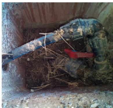
Interior arqueta 40x40 connexió aigua potable a cabina sanitària
