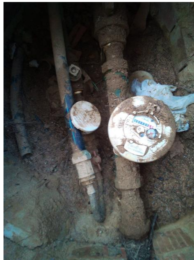
Interior arqueta tipus amb comptador i connexió a general
