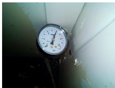
Manòmetre amb pressió actual a instal·lació interior cabina sanitària
