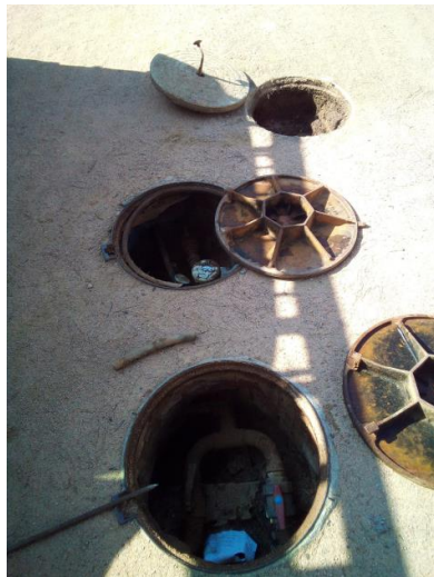
Arquetes de connexions aigua potable amb comptadors
