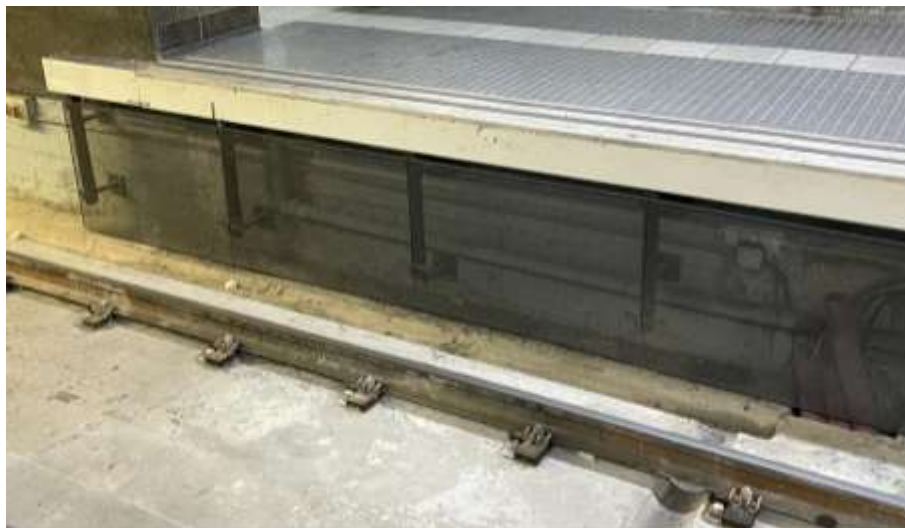
Solució implementada a l'estació de Barcelona – Plaça Catalunya : Safates metàl·liques perforades
