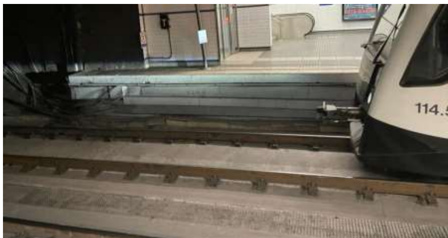
Situació actual a l'estació de Provença : Safates metàl·liques planes i llises amb separació de cablejats per tipologia de servei.
