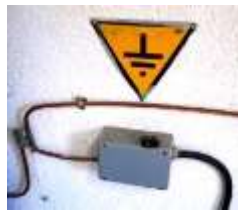
Conexió a terra
