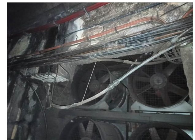
Imatge 44. Manca de reordenació cablejats
