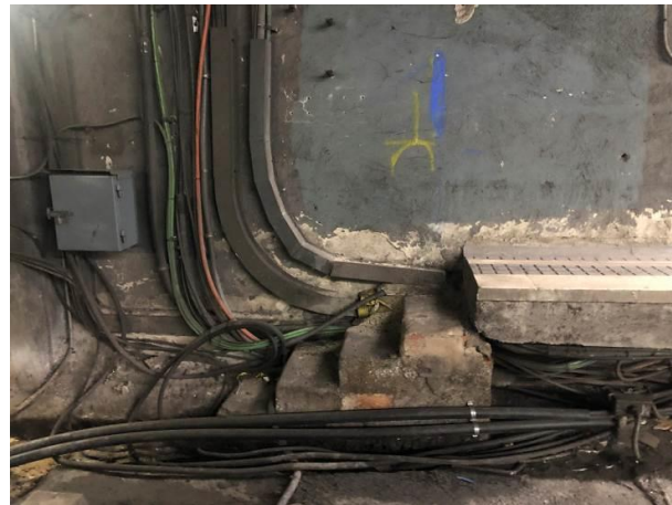
Imatge 23. Escala de via deteriorada
