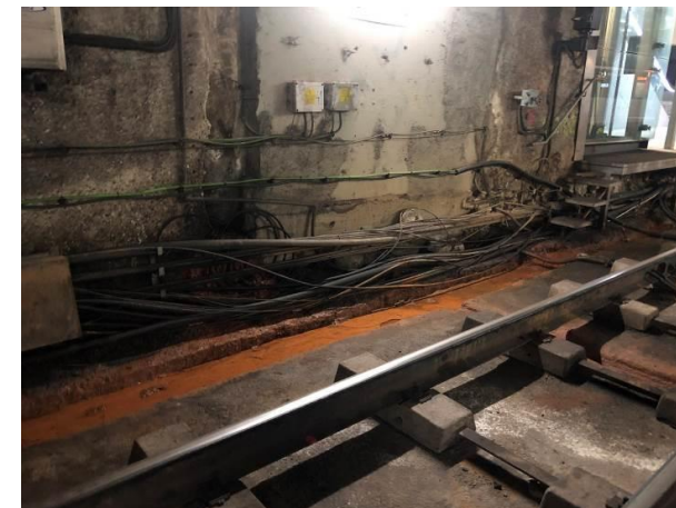
Imatge 29. Cables despenjats
