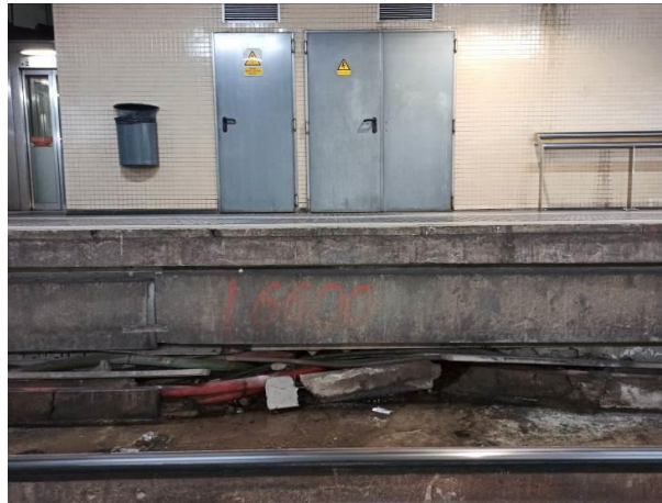
Imatge 53. Canalització de formigó derruïda
