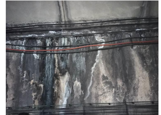
Imatge 50. Cables despenjats
