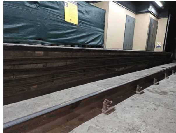
Imatge 54. Cables despenjats
