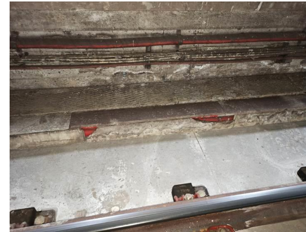
Imatge 41. Canalització de formigó deteriorada
