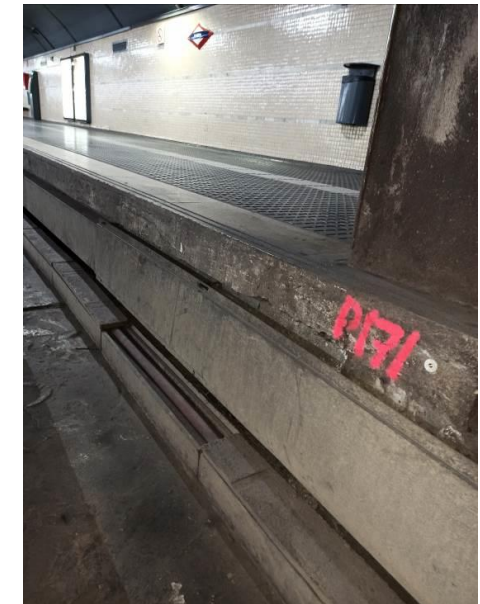
Imatge 52. Manca de tapes de canalització de formigó
