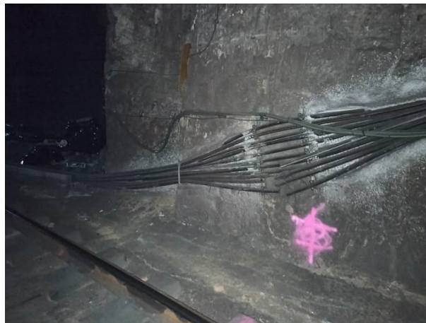
Imatge 38. Cable despenjat
