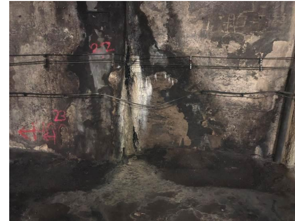
Imatge 34. Cables despenjats
