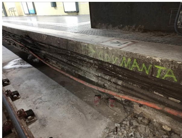
Imatge 63. Cables despenjats
