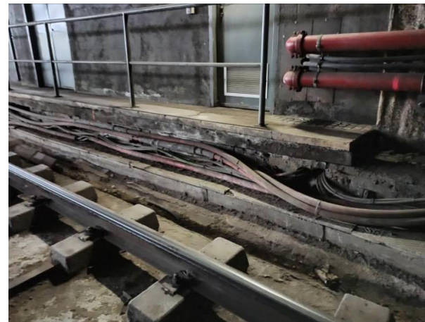
Imatge 39. Cables descol·locats
