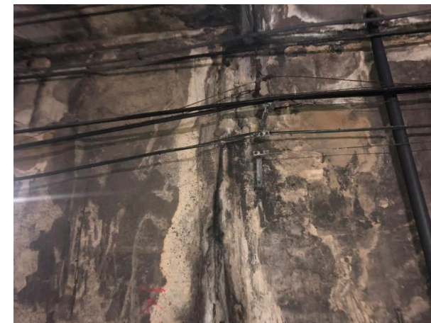
Imatge 19. Fiadors en mal estat
