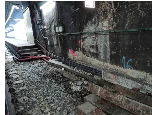
Imatge 59. Canalitzacions deteriorades
