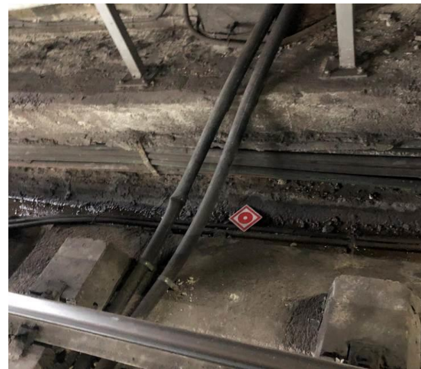
Imatge 24. Peana deteriorada
