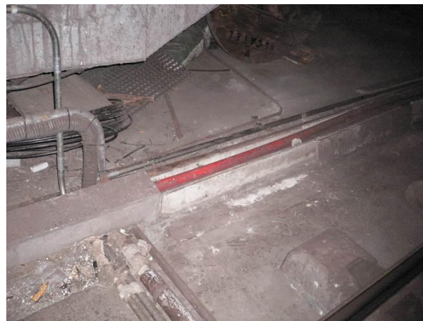
Imatge 1. Absència de tapa en canalització d formigó
