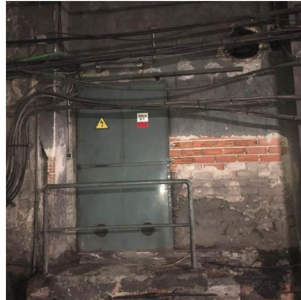
Imatge 22. Manca de pentinat de cables
