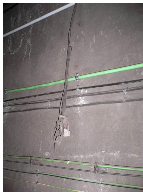
Imatge 3. Cable a retirar
