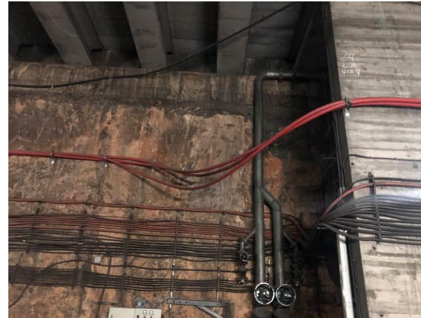
Imatge 10. Cables MT despenjats
