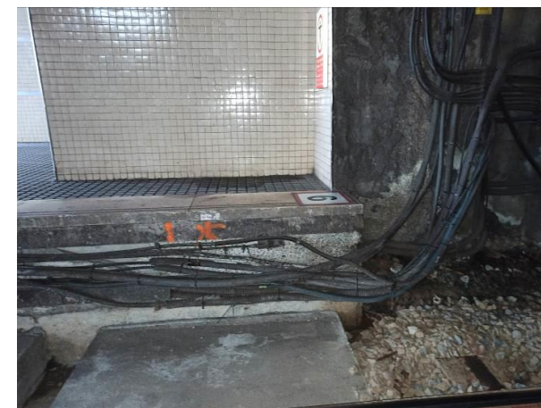
Imatge 43. Cables sense pentinar
