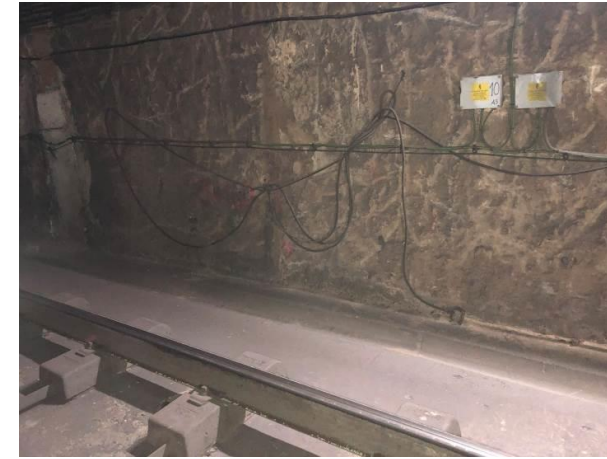
Imatge 15. Cables despenjats
