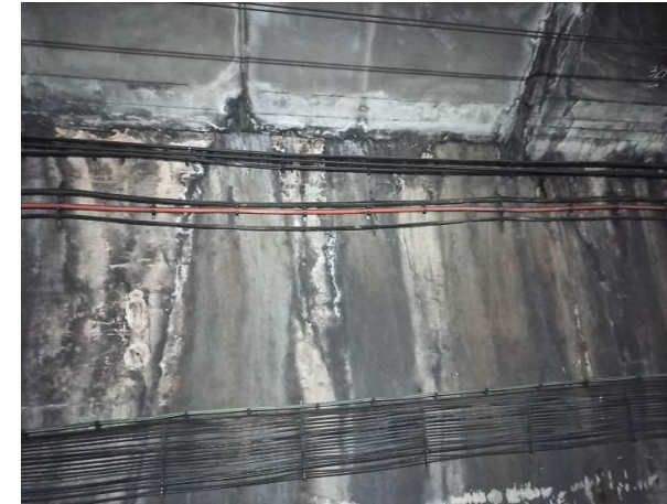
Imatge 57. Cable despenjat
