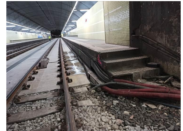
Imatge 60. Absència de canalització
