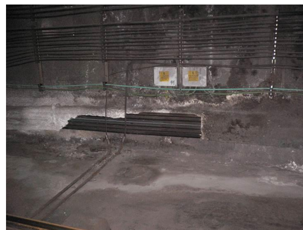
Imatge 4. Manca de gunitat de cables
