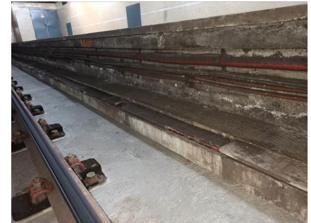
Imatge 42. Tapes de canalització malmeses
