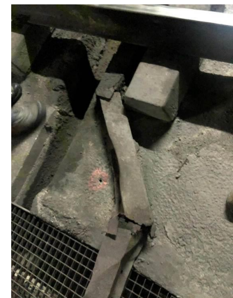
Imatge 20. Canal pas de via en mal estat
