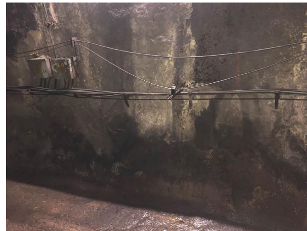
Imatge 33. Cables despenjats
