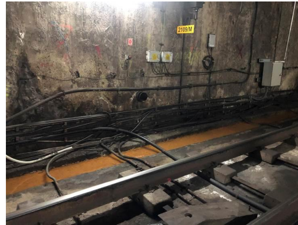
Imatge 31. Cables sense protecció
