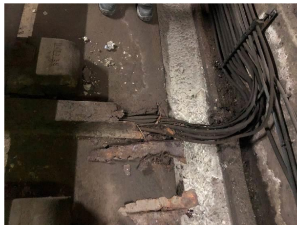
Imatge 13. Canalització de pas de via deteriorada
