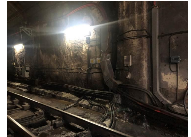
Imatge 26. Xapa protectora de cables deteriorada
