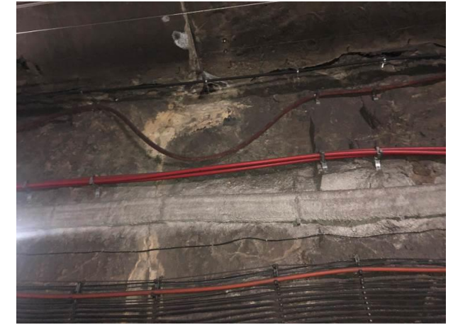
Imatge 16. Cable MT despenjat
