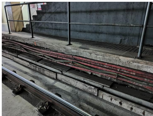
Imatge 40. Cables despenjats
