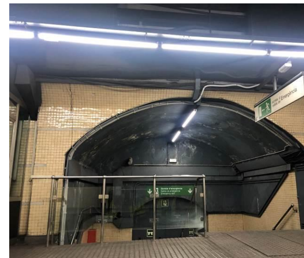
Imatge 7. Cables despenjats
