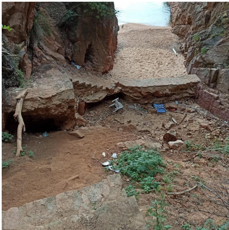
Imatge 11. A l'últim tram, una part de l'escala de mamposteria ha cedit i la resta treballa en voladís ja que l'aigua ha soccavat la base de l'escala.
