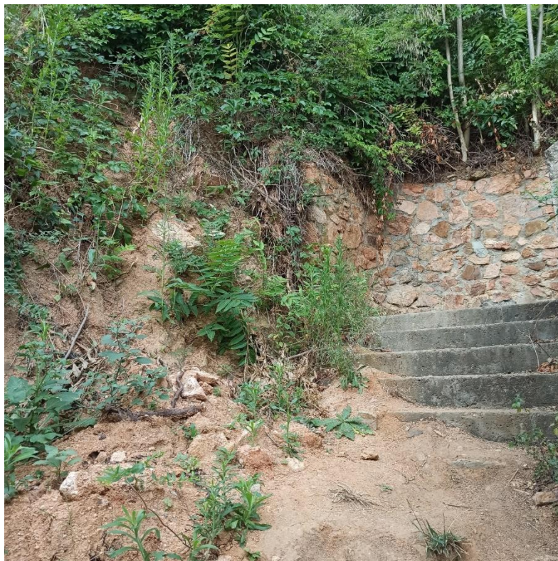
Imatge 7. El mur existent no es prou llarg per contenir les terres que arrastra els temporals.
