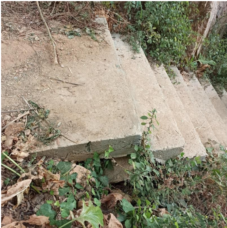
Imatge 10. L'aigua ha soccavat els replans.
