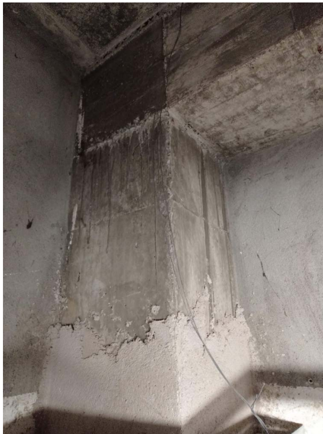
Fotografia de l'estat actual d'un pilar amb l'encontre amb la jàssera penjada
