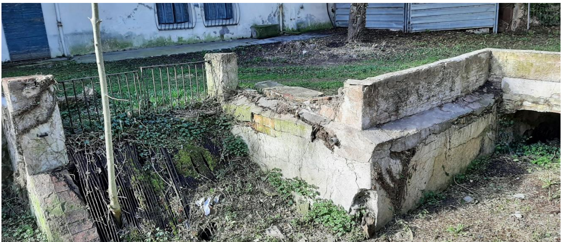
Tram de la barana esfondrada.
