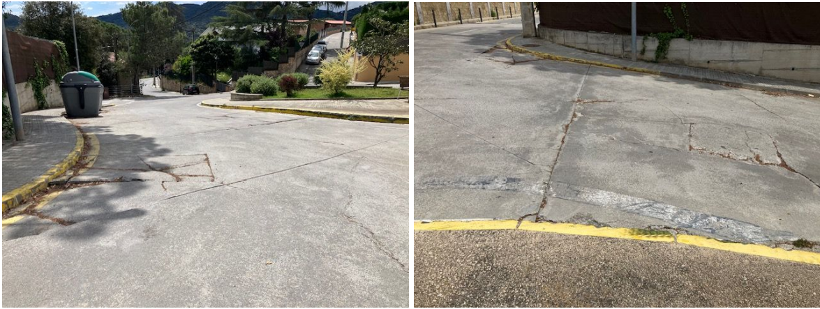
Rotonda de la Carena amb una afectació de 70m2 aproximats
