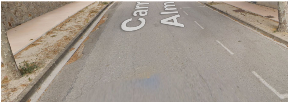
Imatges Google amb detall de trams amb deficiències
