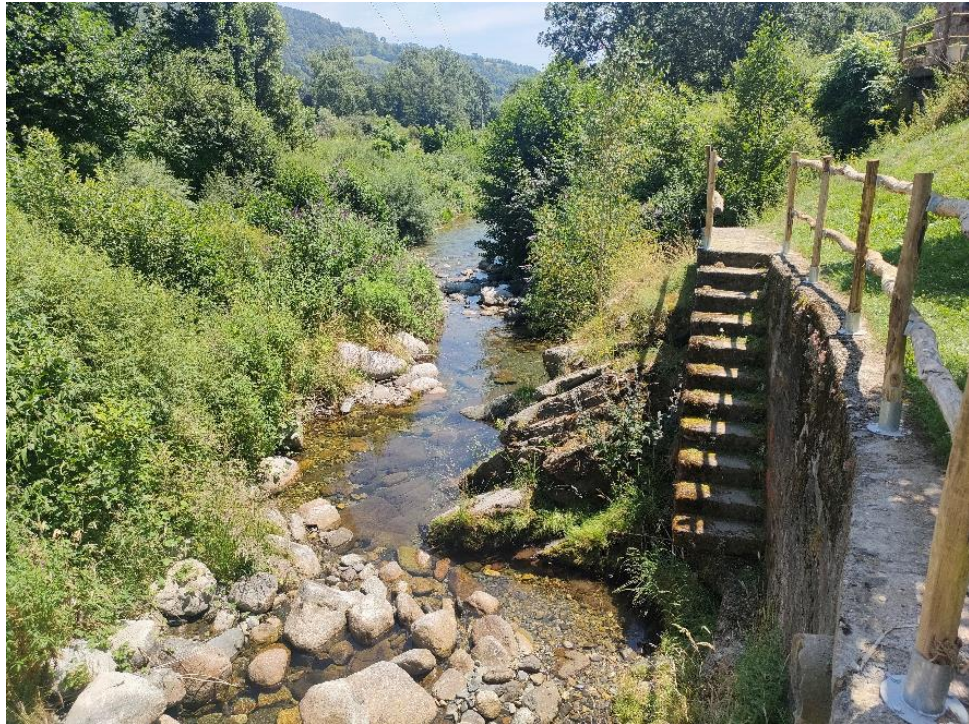
Imatge 6: Zona del riu on ara l'aigua pica amb força a les riuades i va descalçant el mur.
