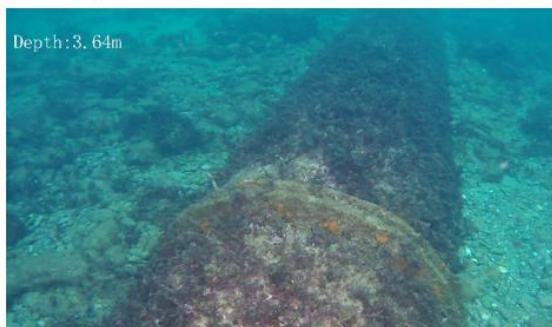
Unió 2 sense protecció:
