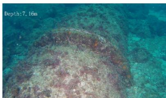
Unió 4 sense protecció:
