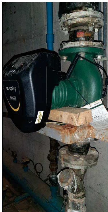
Circulador de l'anell de producció de primari per calefacció a desplaçar.
