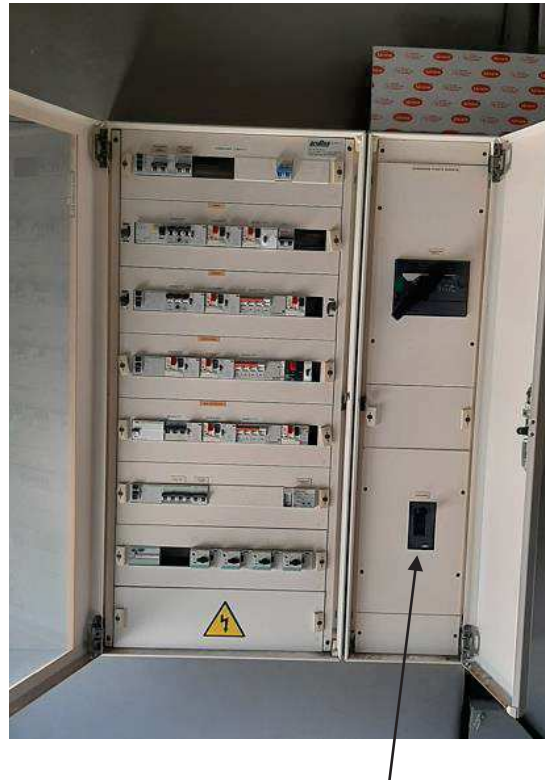
Quadre elèctric màquines planta coberta. Interruptor general refredadora
