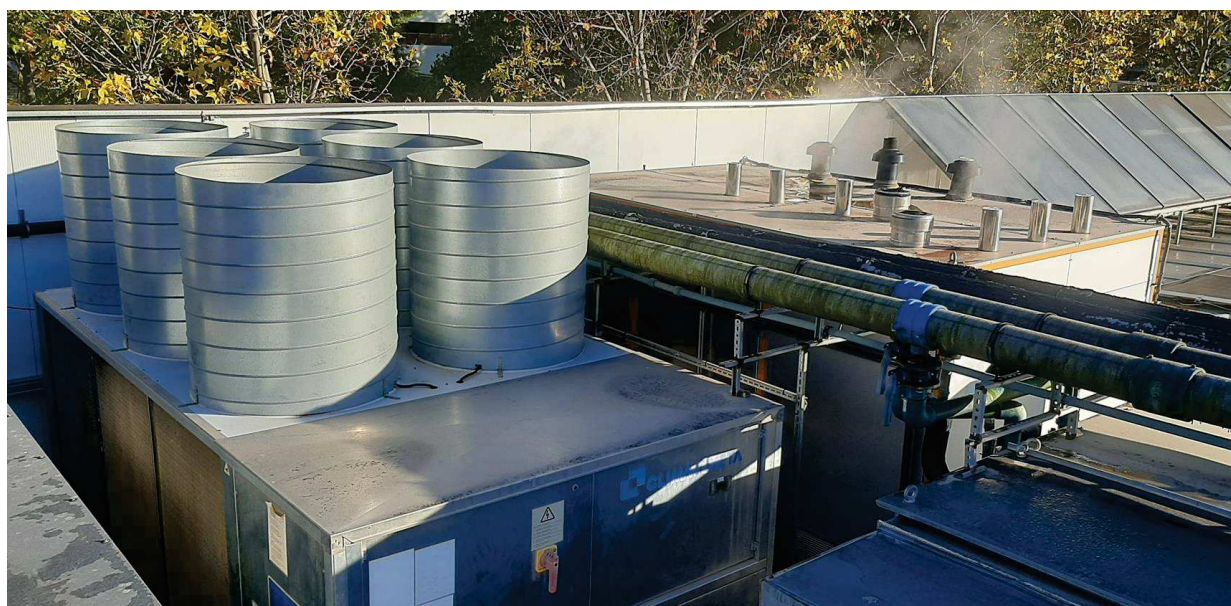
Emplaçament actual de la refredadora i el roof-top amb les calderes al pati de la planta coberta de l'edifici.
