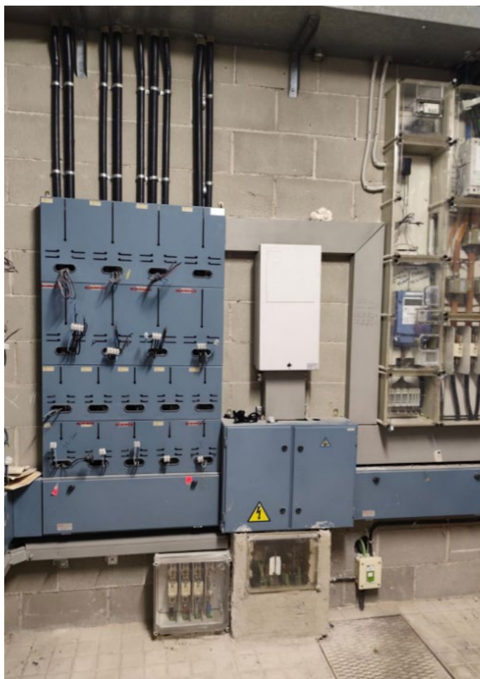
Figura 4: Adequació de la LGA instal·lant tal en carga i sobretensions
