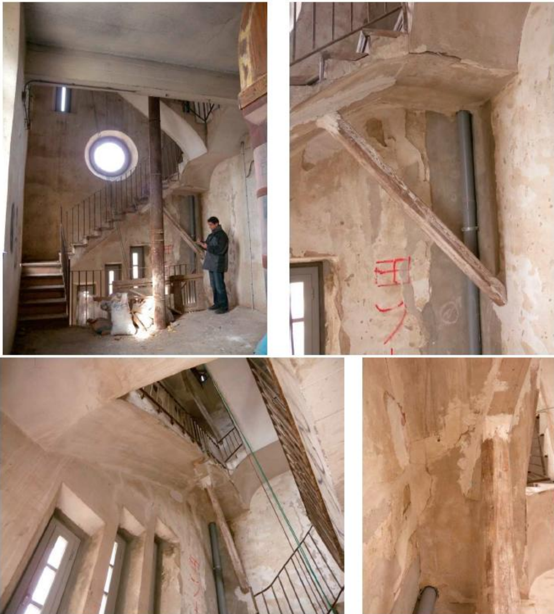
Segon tram d'escala entre planta tercera i quarta (altell), amb diverses esquerdes perpendiculars a la volta que es perllonguen pel mur i que actualment ja es troba apuntalada
