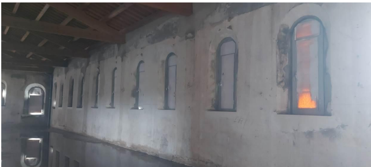
Filtracions d'aigua en planta segona provinents de canals de coberta a la nau lateral est (Carrer Camí Vell de Castellnou)
