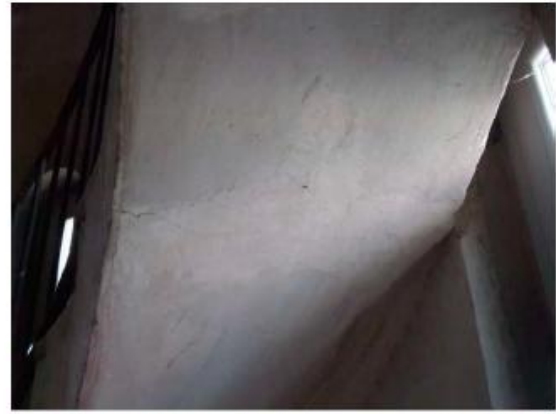
Fissures perpendiculars a la volta al llarg del tram circular d'escala
