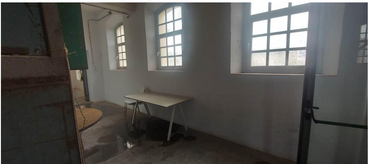
Filtracions d'aigua a l'interior de planta baixa a la nau central
