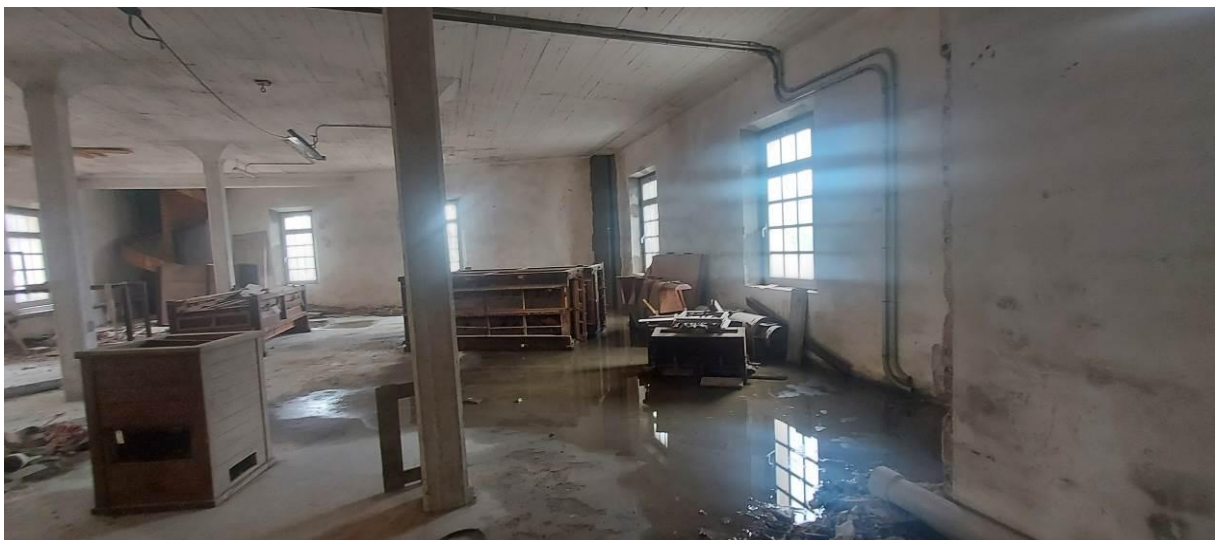
Filtracions d'aigua en planta primera provinents de canals de coberta a la nau lateral est (Carrer Camí Vell de Castellnou)
