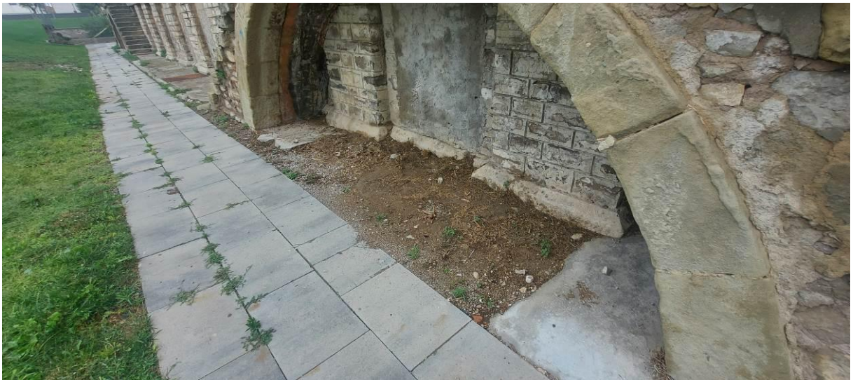
Estat dels murs exteriors en zones de filtracions d'aigua de planta soterrani a la nau central
