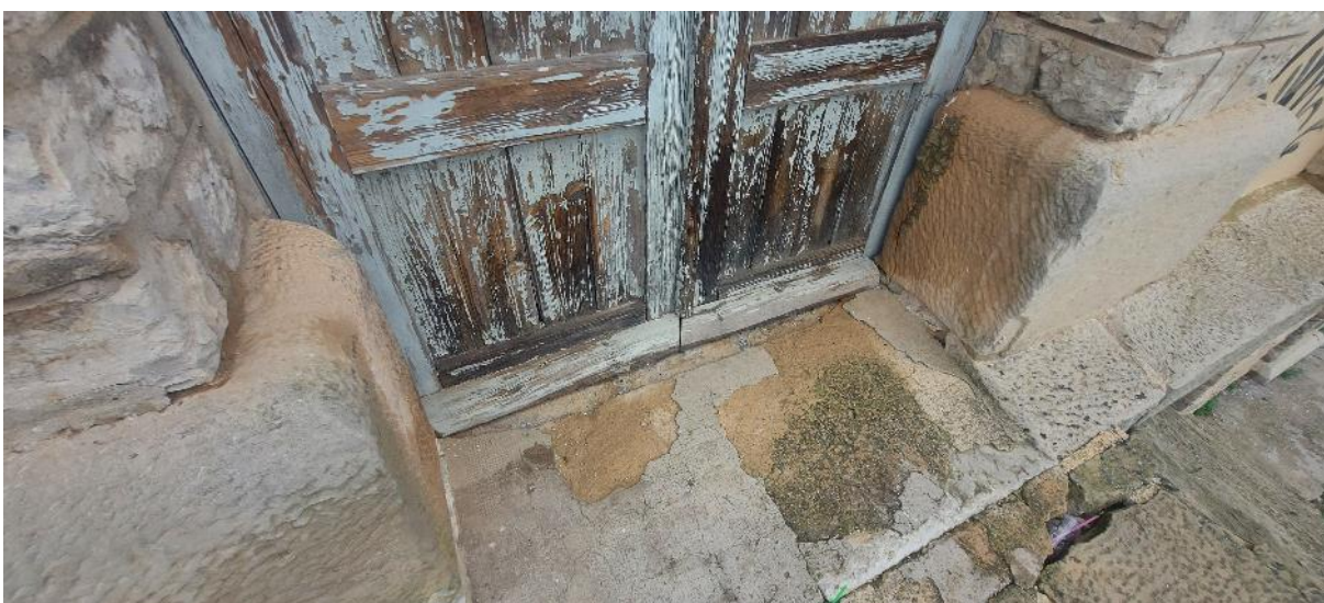
Deficiències en els tancaments practicables en zones amb filtracions d'aigua de planta baixa a la nau central
