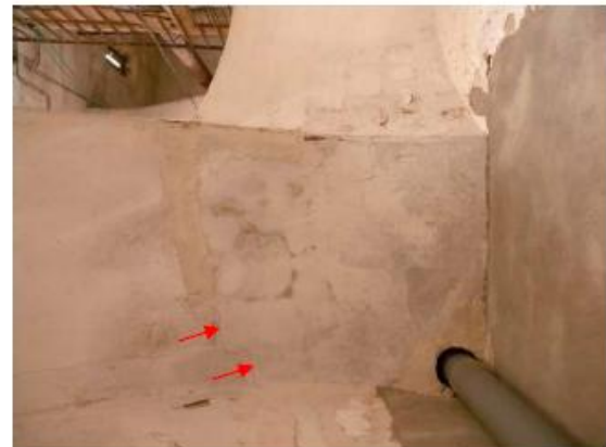
Trobada entre el segon i tercer trams de planta segona a tercera, amb una esquerda perpendicular al seu traçat que continua com a fissura al mur
