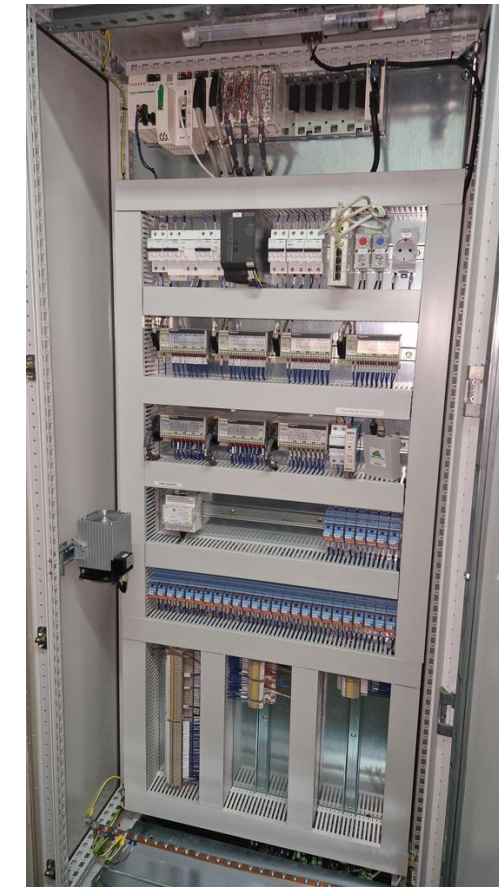
Fotografia 1. Armari CCM existent
