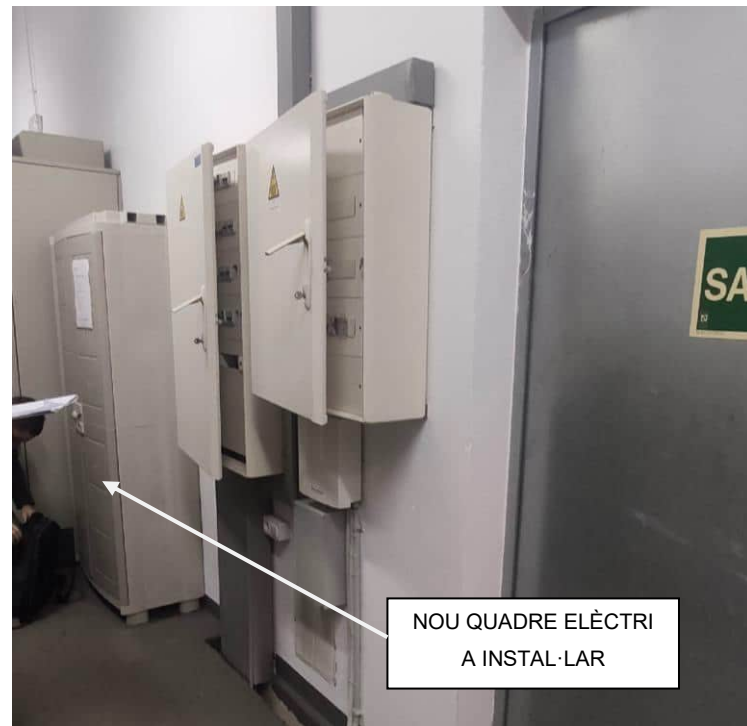
Foto 12.- S'observa la ubicació del nou quadre elèctric, dins la sala de control, es reubicarà l'armari de documentació.
