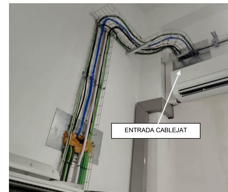
Foto 11.- S'observa l'interior de la sala de control, concretament la ubicació d'entrada de cables elèctrics
