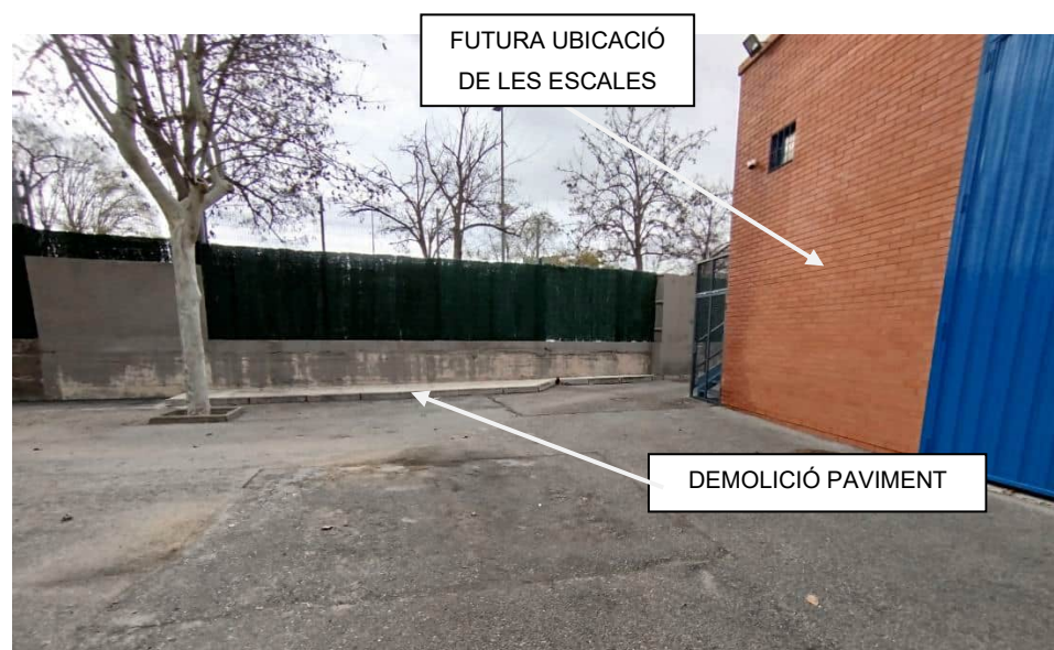
Foto 5.- Ubicació on es reubicaran les escales. També s'observa la secció de paviment que serà eliminada amb raó de facilitar les obres i la instal·lació del polispast. Font: Pròpia
