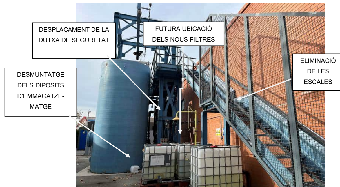
Foto 1.- S'observa la futura ubicació del sistema de remineralització. A més, es distingeixen els sistemes d'emmagatzematge de hidròxid de sodi, antiincrustant, la dutxa d'emergència i les escales, elements que seran desmuntats perquè es col·locaran dipòsits nous dintre de l'edifici d'òsmosis. Font: Pròpia
