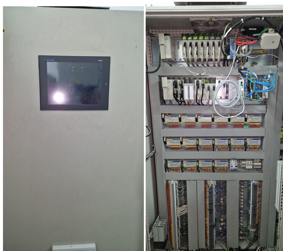
Fotografia 2. Armari secundari elèctric i de control existent (frontal de l'armari fotografia esquerra i interior de l'armari fotografia dreta).
