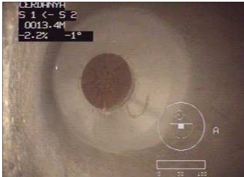
Fotografía: 23a, Nº Video: -----, 00:01:12 13,4m, Fin de la inspección, TRAM AMB RESTAS DE MATERIA
