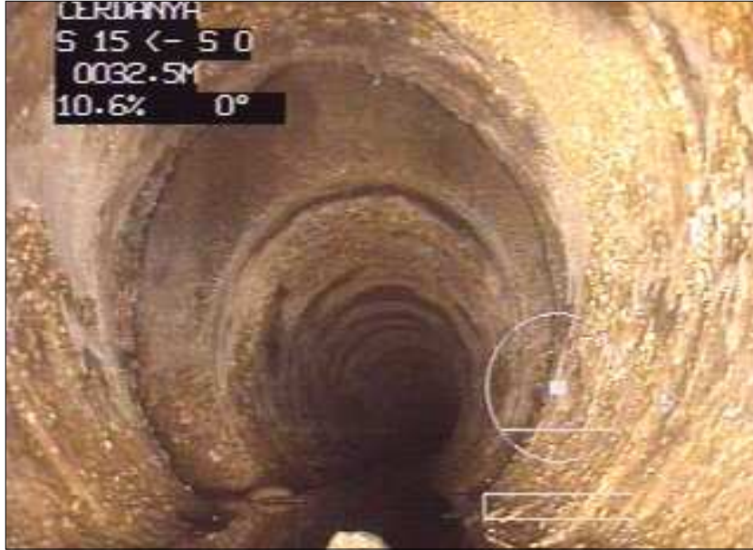
Fotografía: 28a, Nº Video: -----, 00:02:14 32,5m, Fin de la inspección, RESTAS DE MATERIA NO PASSA, FALTAN
