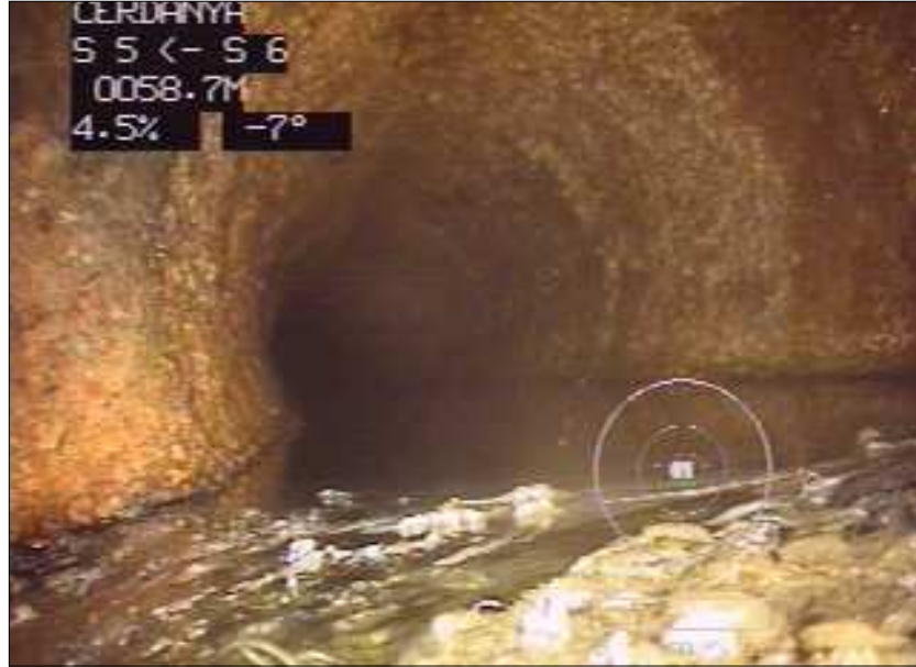
Fotografia: 16b, N° Video: -----, 00:06:18 58,7m, Fin de la inspecció, POU S 6 FONDO AMB MAL ESTAT POSSIBLES
