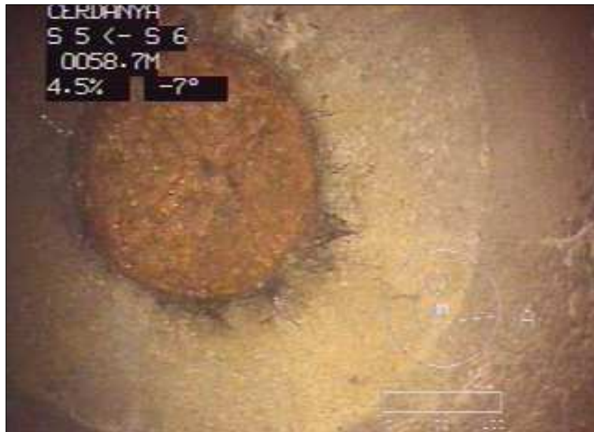
Fotografía: 16a, Nº Video: -----, 00:06:18 58,7m, Fin de la inspección, POU S 6 FONDO AMB MAL ESTAT POSSIBLES
