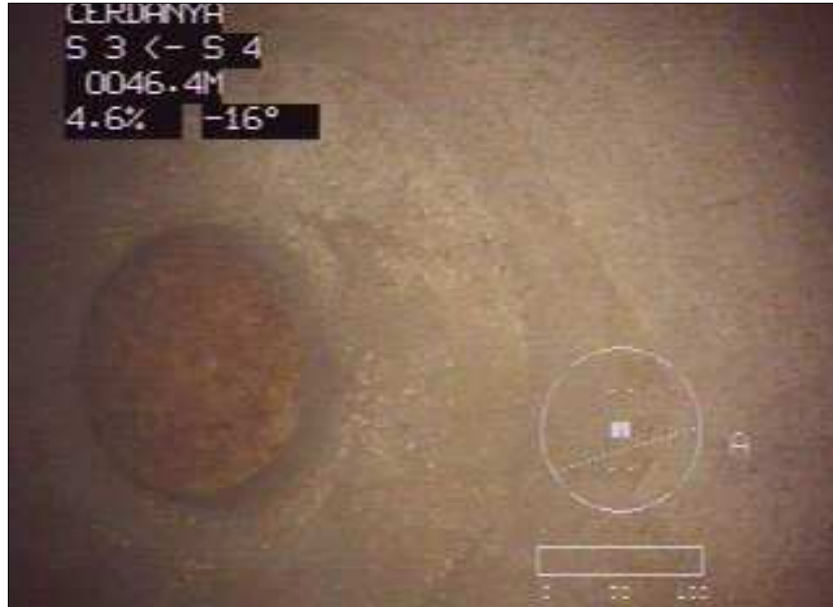
Fotografía: 9a, Nº Video: -----, 00:02:40 46,4m, Fin de la inspección , TRAM AMB RESTAS DE PEDRAS 13,5 M.
