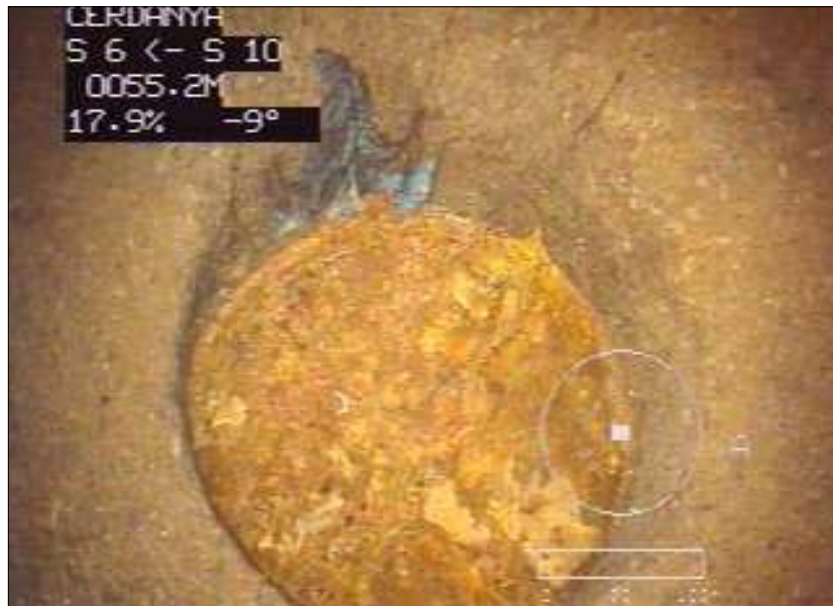
Fotografía: 19a, Nº Video: -----, 00:04:02 55,2m, Fin de la inspección , TRAM AMB ESQUEDAS PART SUPERIOR I DT I ESQ
