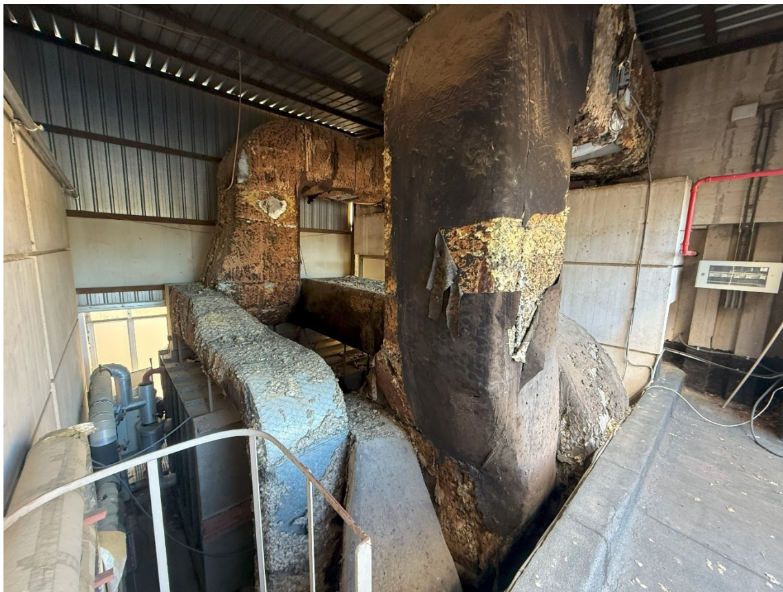
Fig. 3. Climatitzador i conductes actuals
