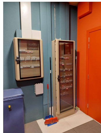
A-8 Quadre elèctric a l'entrada LAb
