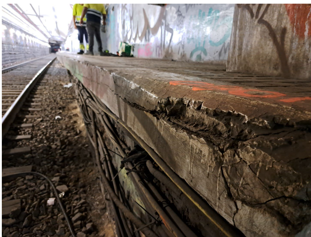
Foto 3. Esquerda longitudinal per corrosió de l'armat
