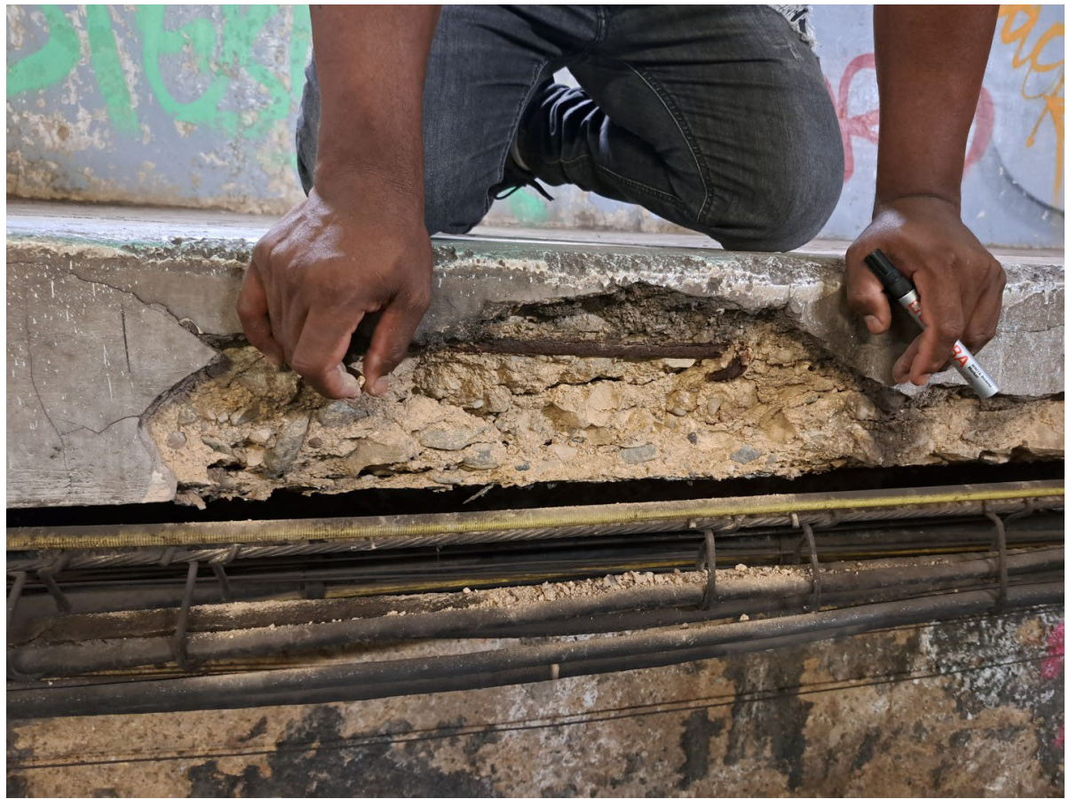
Foto 2. Corrosió de l'armat i mala qualitat del formigó
