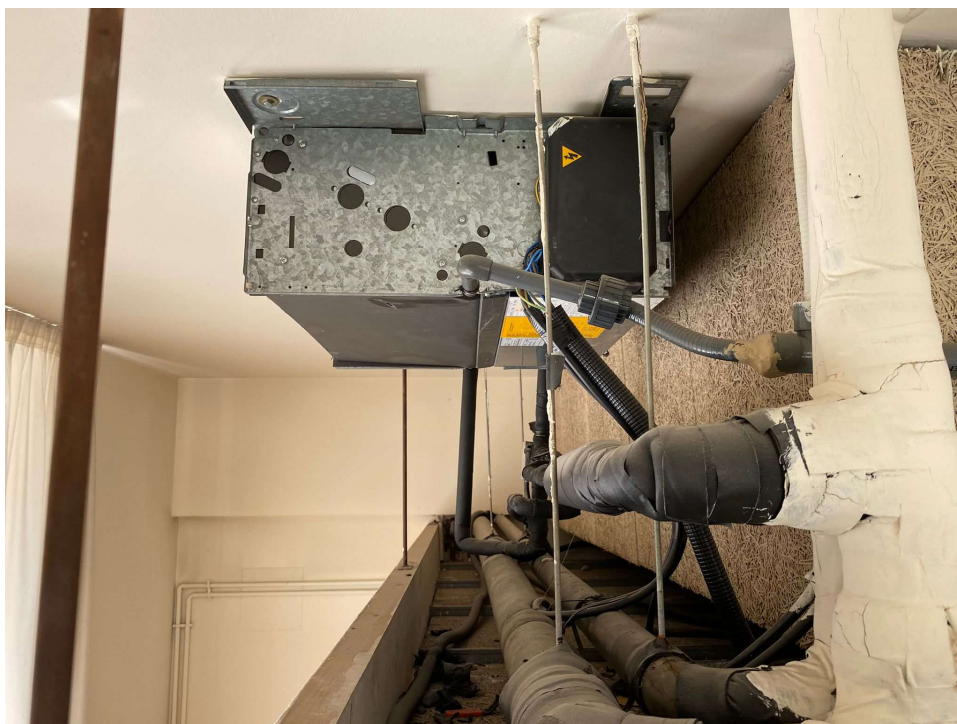
Fotografia 2. Unitat interior existent amb les connexions a sistema centralitzat distribució d'aigua i evacuació dels condensats
