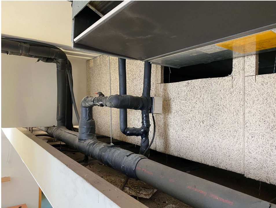
Fotografia 1. Unitat interior existent amb les connexions a sistema centralitzat distribució d'aigua
