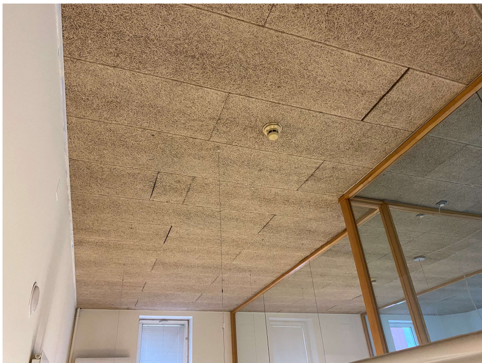
Fotografia 4. Detector d'incendis existent a reubicar
