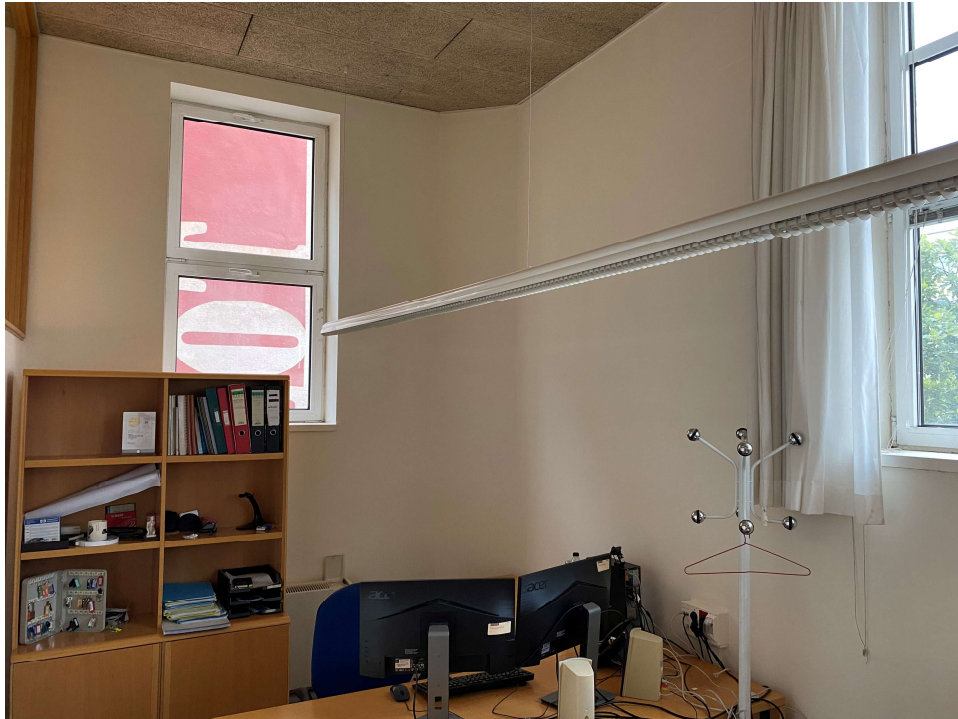
Fotografia 3. Lluminiària decorativa suspesa a substituir
