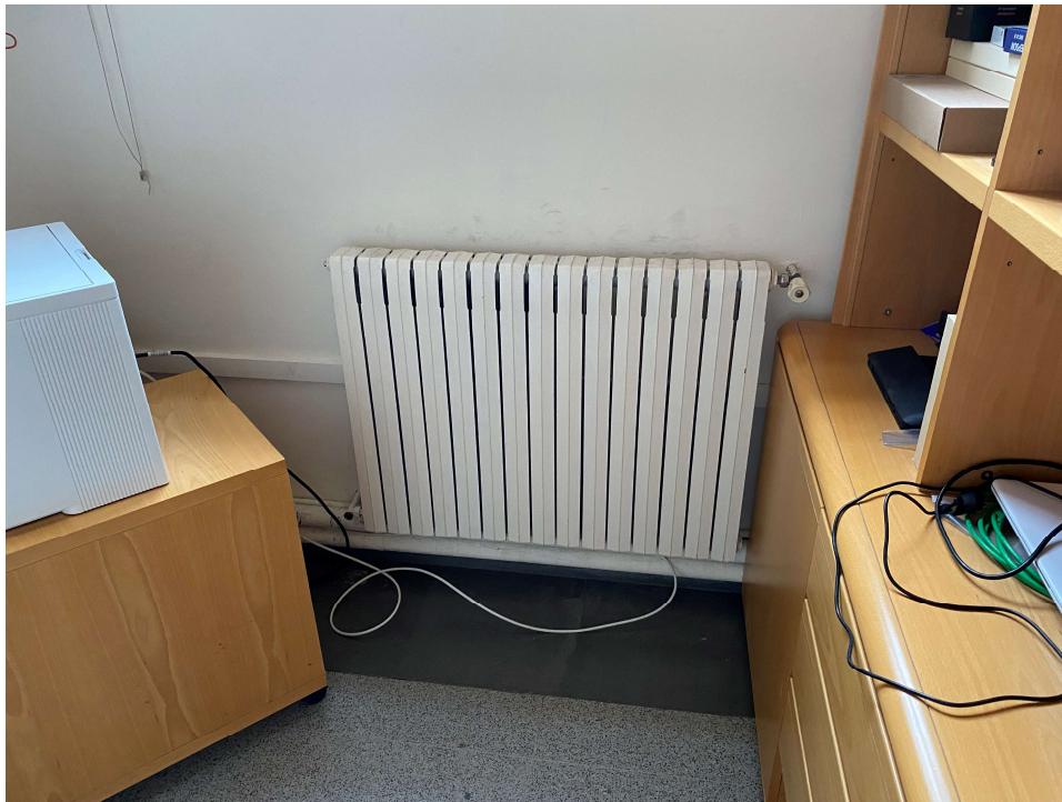
Fotografia 1. Radiador de fosa existent a mantenir
