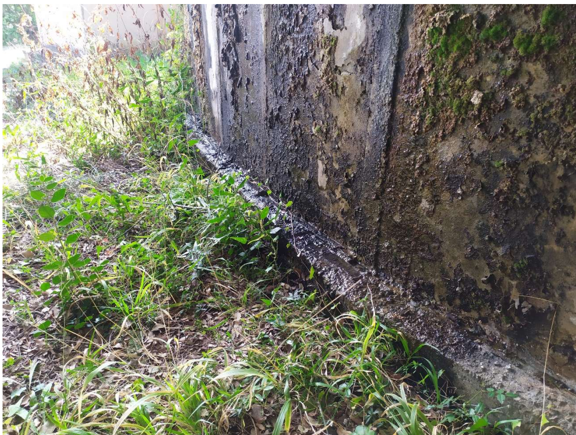
Foto 49: Actuació 2, estat actual fuites dipòsit
