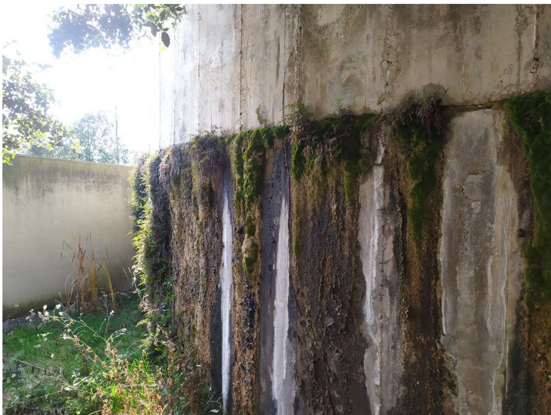
Foto 48: Actuació 2, estat actual fuites dipòsit
