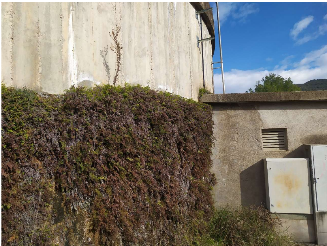
Foto 46: Actuació 2, estat actual fuites dipòsit
