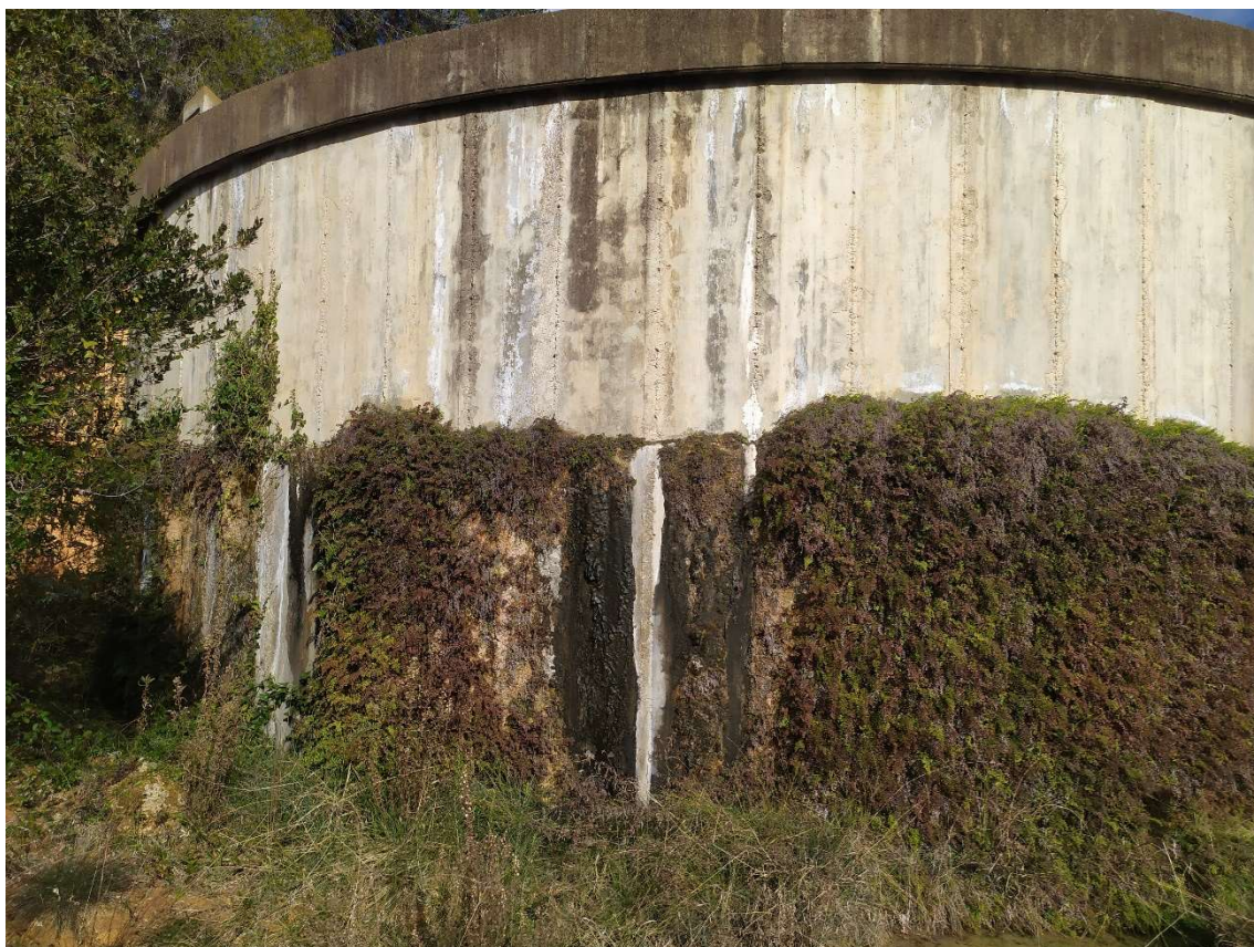
Foto 45: Actuació 2, estat actual fuites dipòsit
