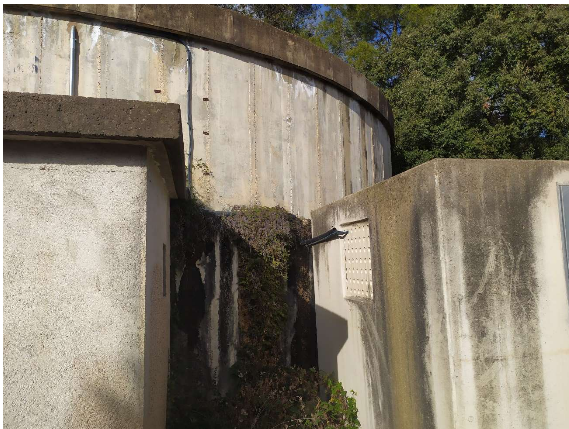
Foto 47: Actuació 2, estat actual fuites dipòsit
