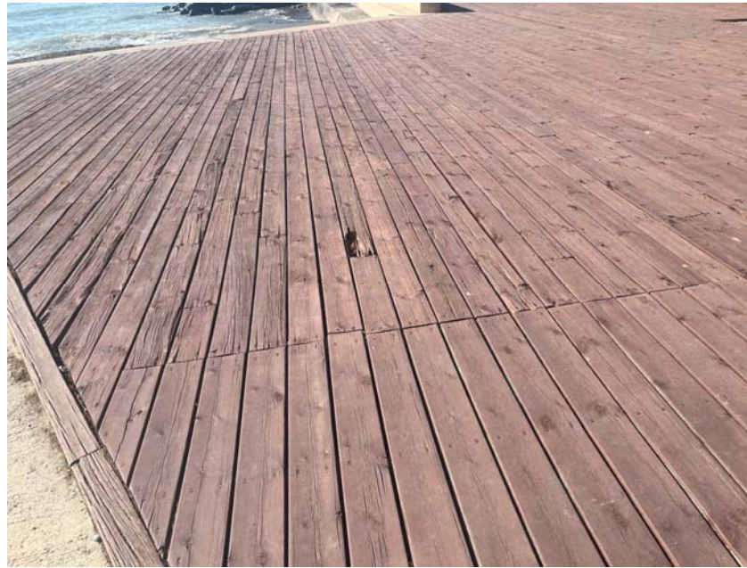
Fotografia 16: Desperfectes de la tarima
