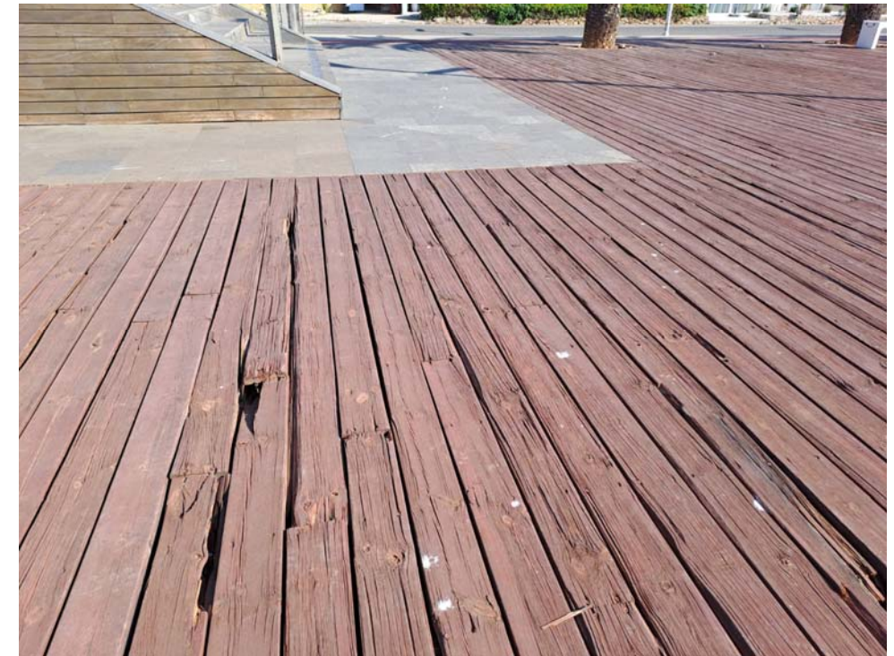
Fotografia 18: Desperfectes de la tarima
