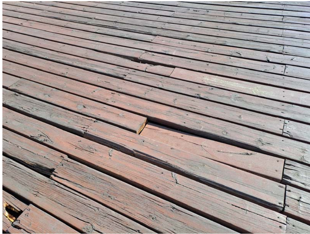
Fotografia 24: Desperfectes de la tarima
