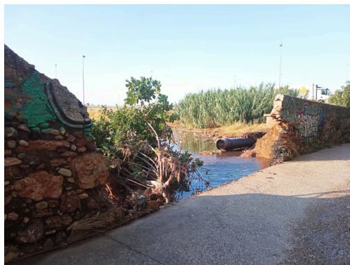
Col·lapse Mur Riera Pahissa, creuament canal infanta
