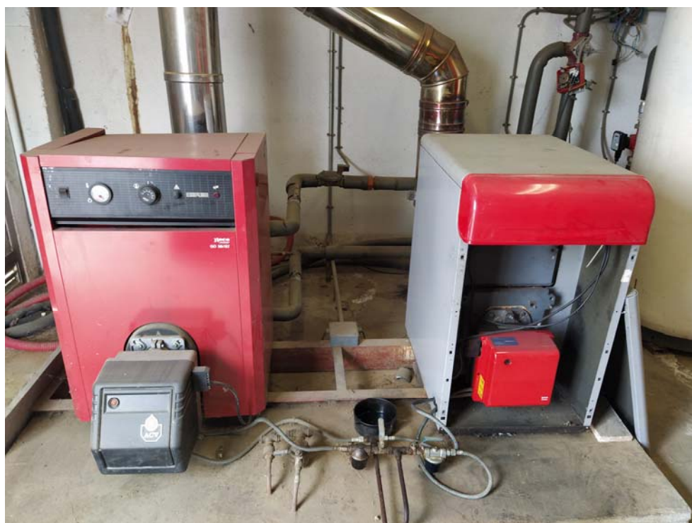
Caldera ROCA GO 50/GT i caldera FERROLI GN M UNIT 03 30
