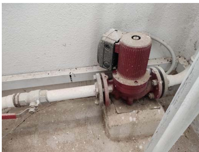
Bomba de recirculació GRUNDFOS.
