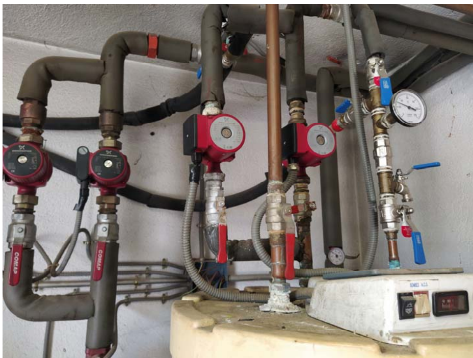
Bombes de recirculació GRUNDFOS UPS 32-80 180 i GRUNDFOS UP 20-30 150
