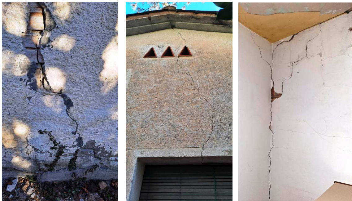
Imatges de les lesions presents a l'edifici
