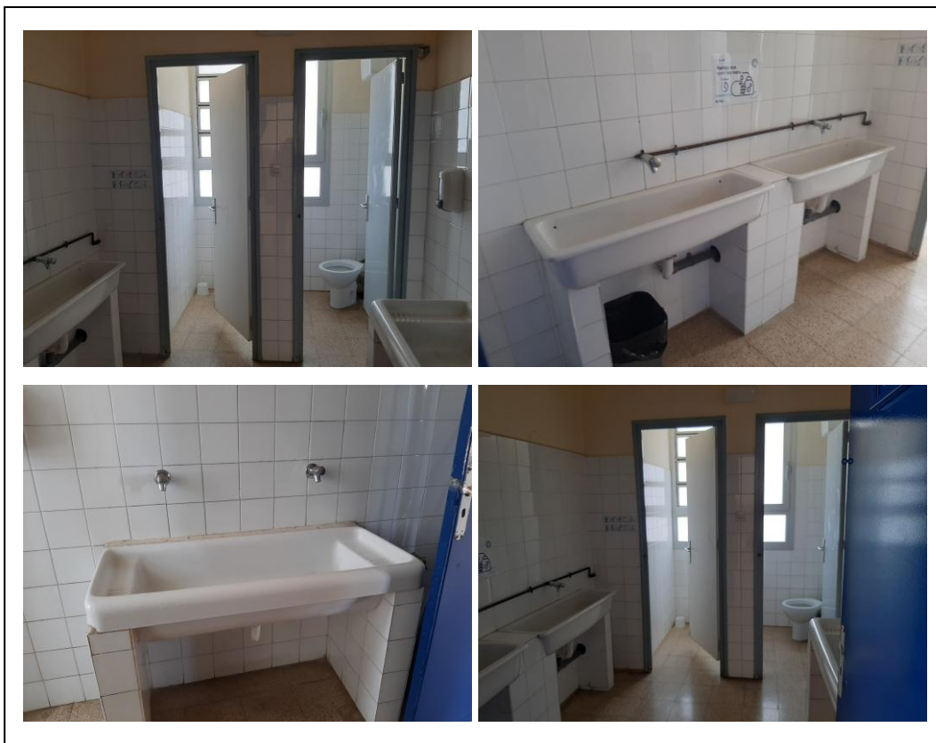
Actuació 6. Estat actual de cambres higièniques
