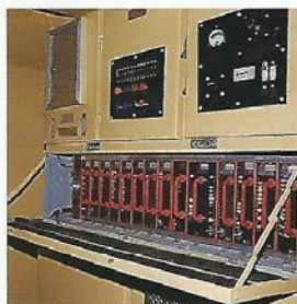
Armari de control dins de la cabina
