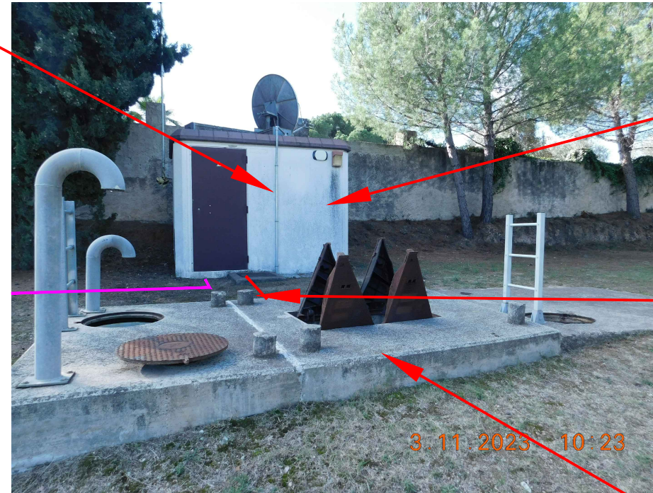
Nou analitzador interior dins caseta elèctrica existent
