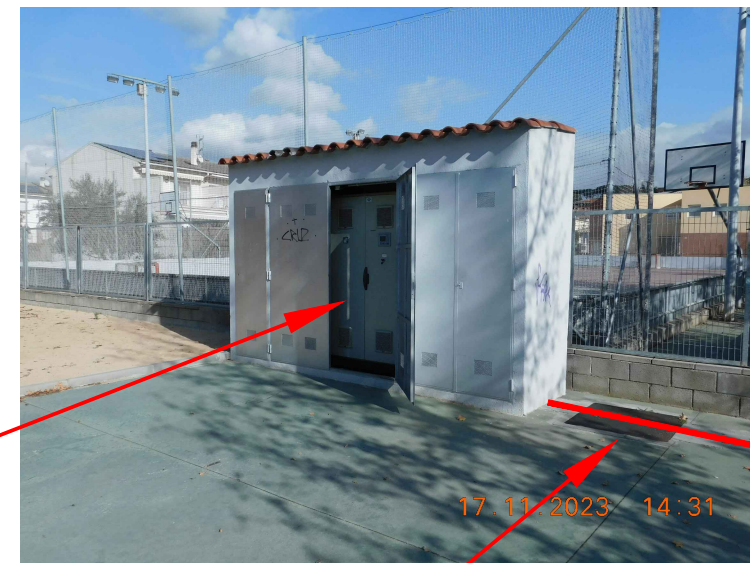
Caseta elèctrica i de control
