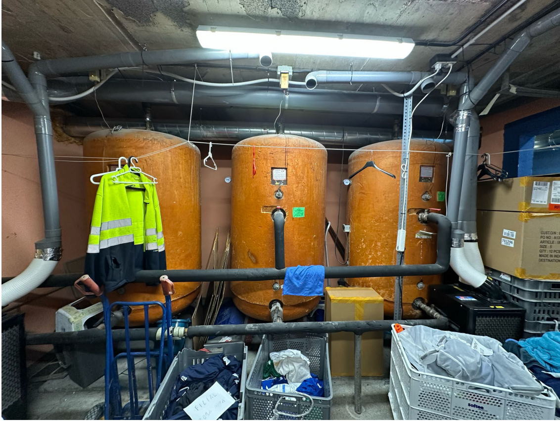
Sala de calderes
