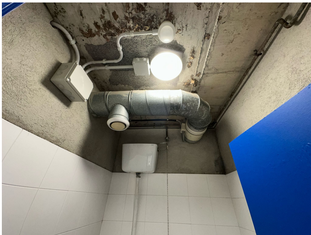
Detall patologies del forjat
