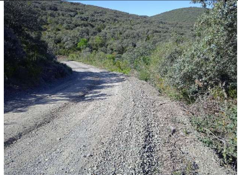
Camí del Pantà de Canelles, on el ferm està malmès per l'aigua i no hi ha cap trencaigües ni cuneta que afavoreixi l'evacuació de l'aigua
