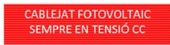
Figura 16. Senyalització cablejat CC. Font: Bombers de Barcelona.
